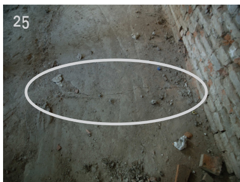
25 - Piano primo chiostro sud. Fessura che riprende la struttura della volta del chiostro sottostante.
