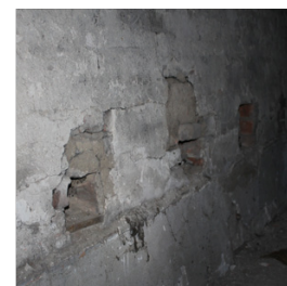
IMG_14 Segni dell'alloggiamento delle travi del solaio ligneo, sostituito con uno nuovo in laterocemento
