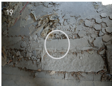
19 - Piano primo blocco centrale. Fessura di cedimento sullo stipite in corrispondenza di una volta sottostante.
