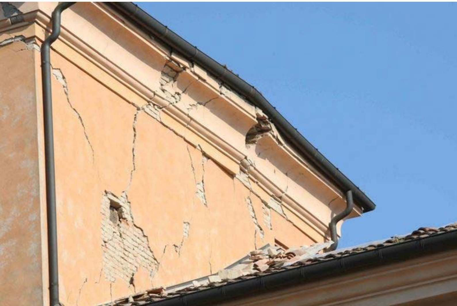
fig. 39 Palazzo Sartoretti gravemente danneggiato dagli eventi sismici di maggio
