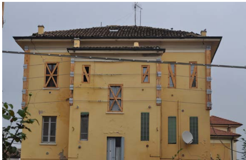
fig. 102-103-104 Palazzine anni '40, gravemente danneggiate dal sisma
