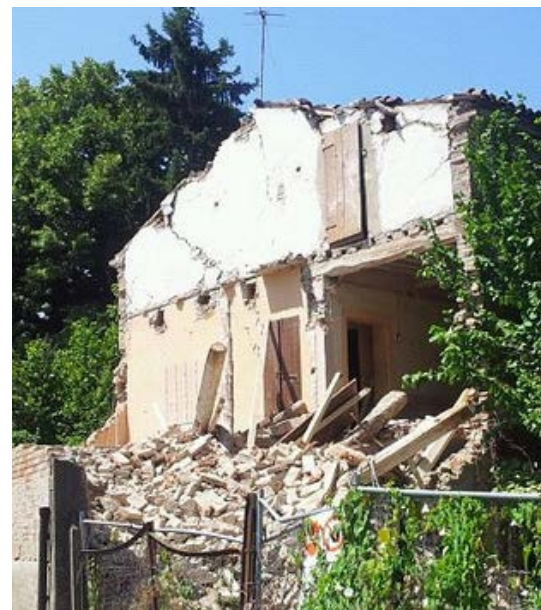
fig.41-42-43-44-45 Danni agli edifici dopo le scosse del 29 maggio
