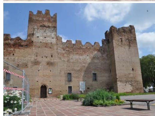
fig. 32-33-34 Danni agli edifici dopo la scossa del 20 maggio
