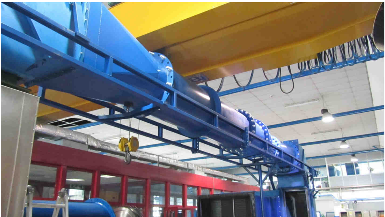
Figura 1.5: Parte superiore impianto di nuova concezione.
