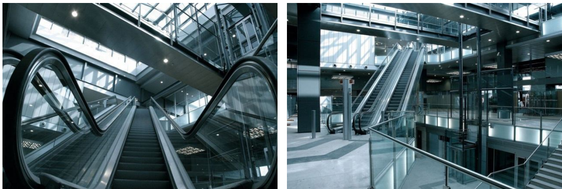
Figura 15: le scale mobili di Milano Porta Garibaldi che connettono il piano terra con gli uffici del piano superiore
