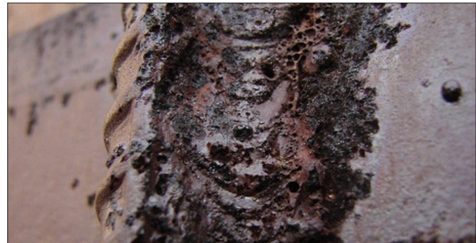
Immagine 12. Attacco corrosivo localizzato sulla saldatura. Fonte: Celestina Adams.
