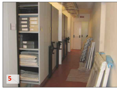
5 Lo spazio disponibile lungo via di fuga verso la doppia porta REI, anche essendo di dimensioni a norma (1,45 m) risulta ridotto a causa di materiale accatastato lungo la via di fuga stessa.
