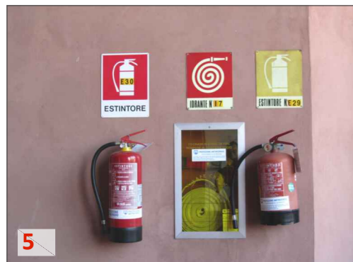
5 Dispositivi di emergenza al piano primo
