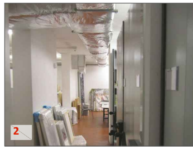
2 La presenza di materiale vario dislocato lungo le vie di fuga e lungo le pareti potrebbe interferire negativamente con l'esodo forzoso degli operatori presenti all'interno del deposito archivio climatizzato, creando problemi di intralcio, inciampo e caduta.
