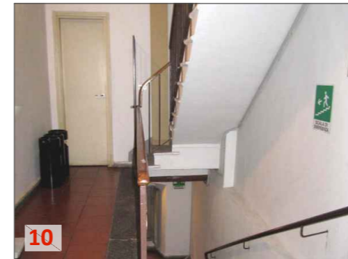
10 Servizio igienico non accessibile al p. primo
