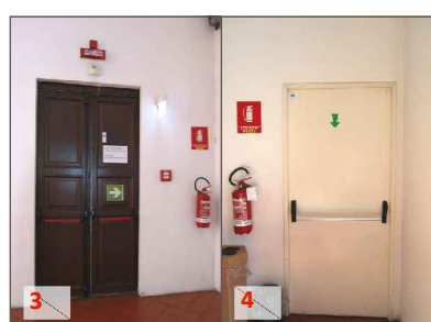
Nella sala dedicata al Servizio Educativo, la segnaletica utilizzata per indicare le uscite di emergenza (foto a sinistra) e la via di fuga (foto a destra) non è a norma e potrebbe creare confusione nell'utenza, compromettendone l'esodo forzoso.
