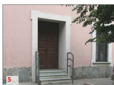
L'affaccio della porta di emergenza sulla via Frova, con un dislivello di tre gradini, non è regolamentare e potrebbe creare problematiche di caduta dall'alto in caso di esodo forzoso dell'utenza.
