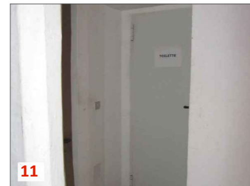
11 Servizi igienici non accessibili al p. ammezzato
