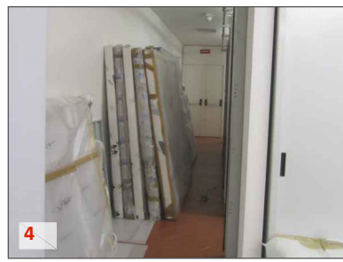
4 La presenza di materiale accatastato lungo le pareti riduce notevolmente il passaggio disponibile (nel caso in esame 1,46 m) per l'esodo degli operatori, costringendo eventuali disabili a trovare vie di fuga alternative.
