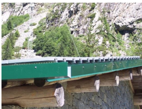
Figura 3-6: struttura di sostegno dei moduli PV
