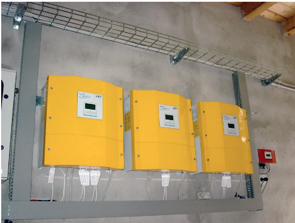
Figura 3-11: convertitori di batteria
