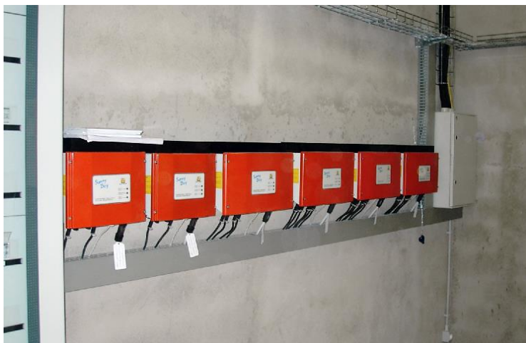
Figura 3-10: inverter di generatore fotovoltaico
