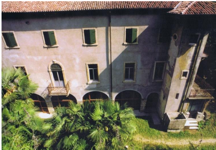
Figura 66: La facciata Ovest della Villa in una fotografia dopo l'intervento di restauro
