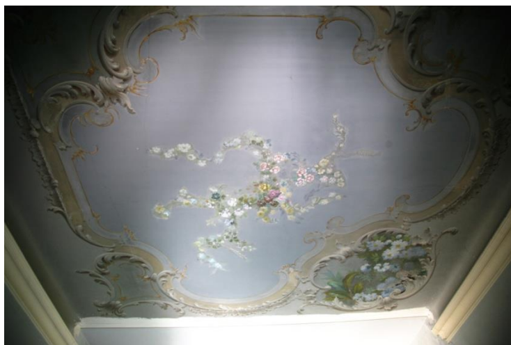
Figura 107: Villa _ soffitto servizi igienici (P1).
