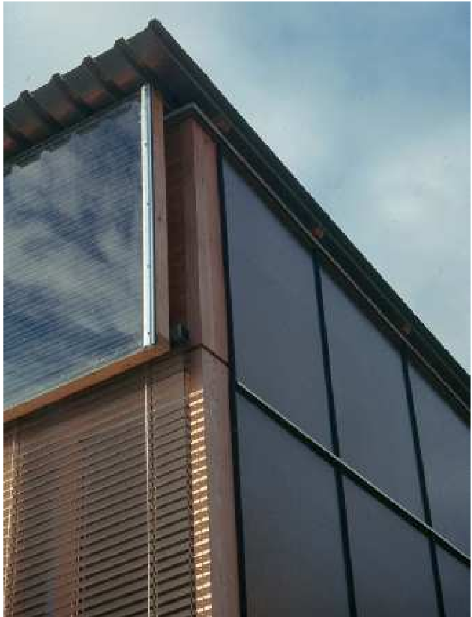
Fig. 123: particolare in cui si notano: i collettori solari, le veneziane esterne e l'involucro
