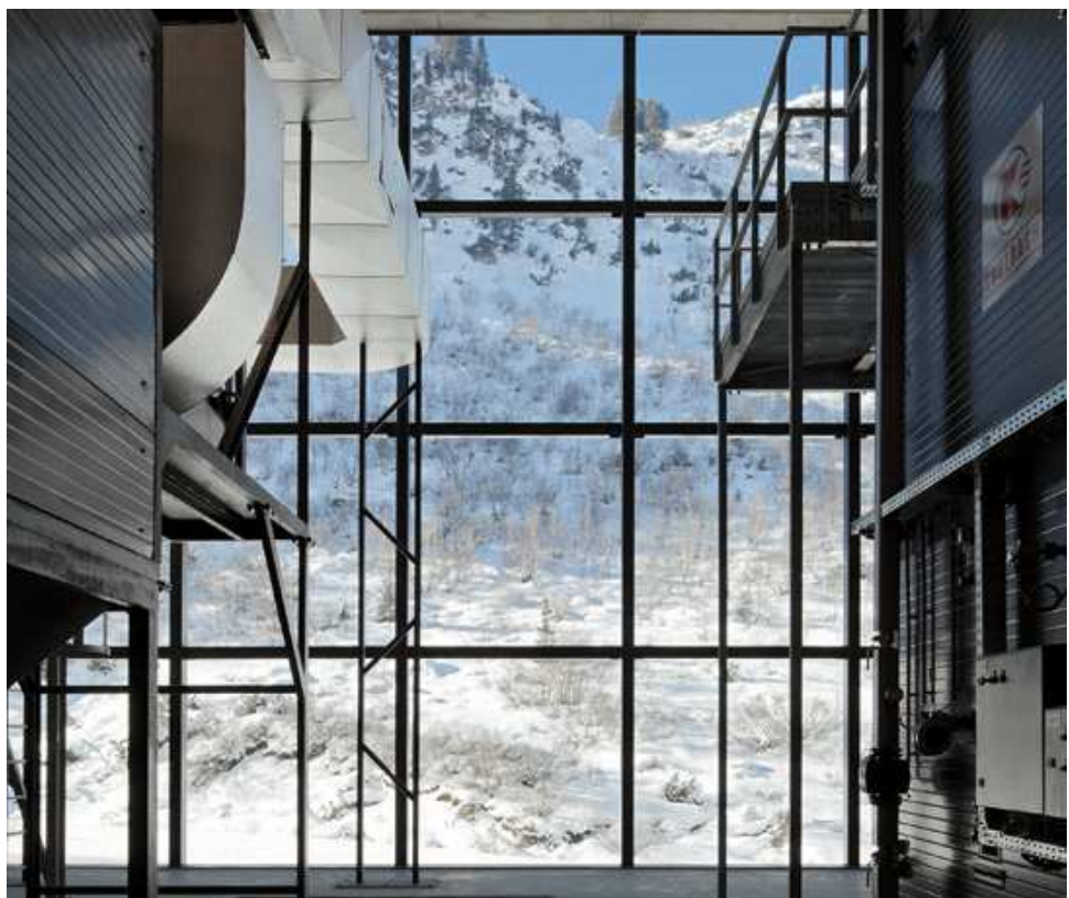
Fig. 351: fotografia interna della centrale
