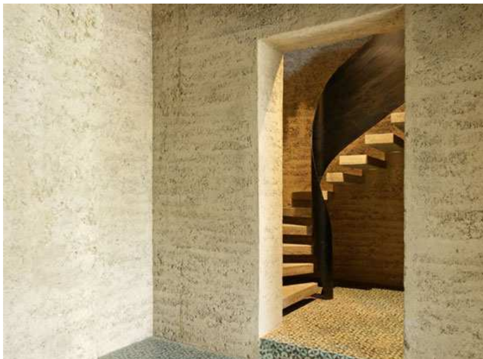
Fig. 286: le scale e il relativo vano in terra cruda compatta, notare i gradini a sbalzo
