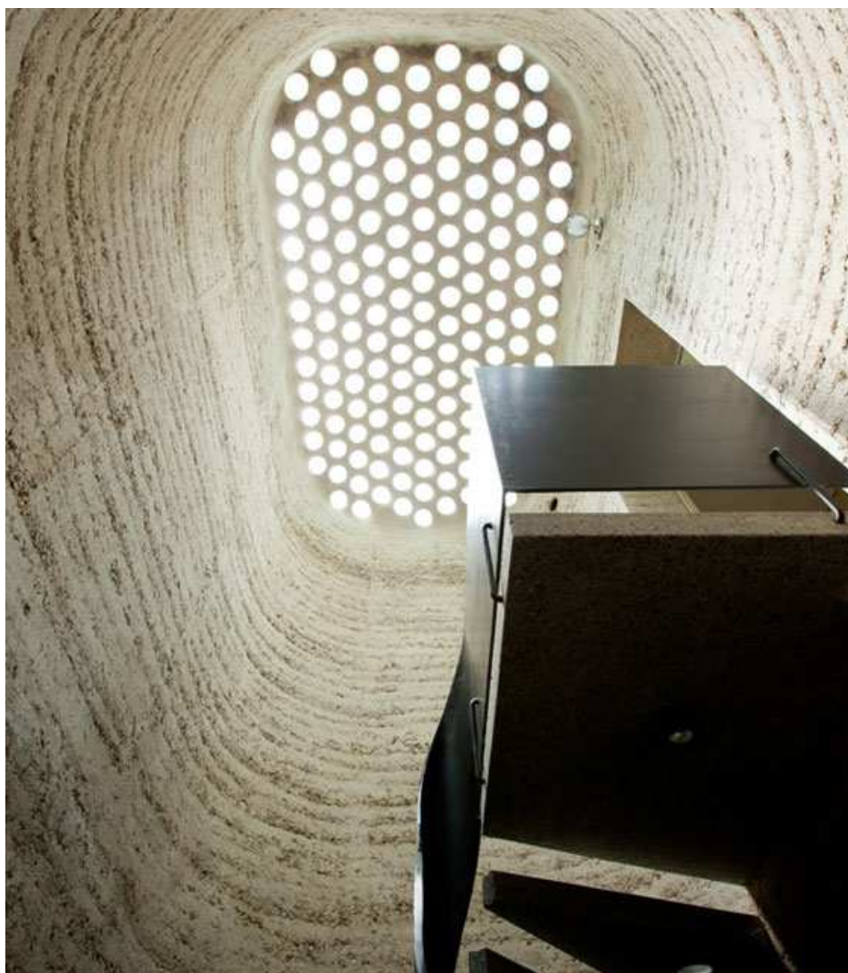
Fig. 287: foto del vano scale con il lucernario in terra cruda forato da elementi vetrati
