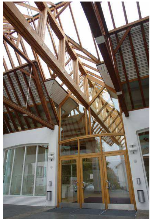
Fig. 100: l'ingresso con la trave reticolare
