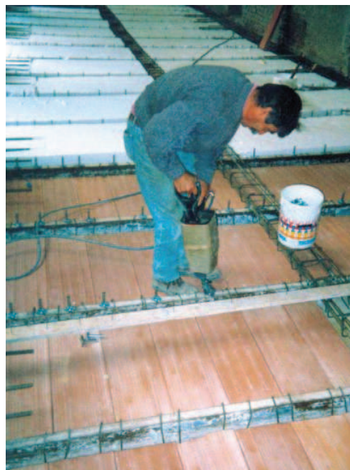
Fig. 15.6. e fig. 15.7. - A sinistra: Infissione dei connettori mediante chiodatrice a sparo e realizzazione di cordoli armati perimetrali.
