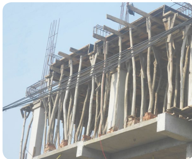
sotto: bamboo usato come elemento per puntellare i solai durante le operazioni di cantiere in basso: bamboo usato come impalcatura
