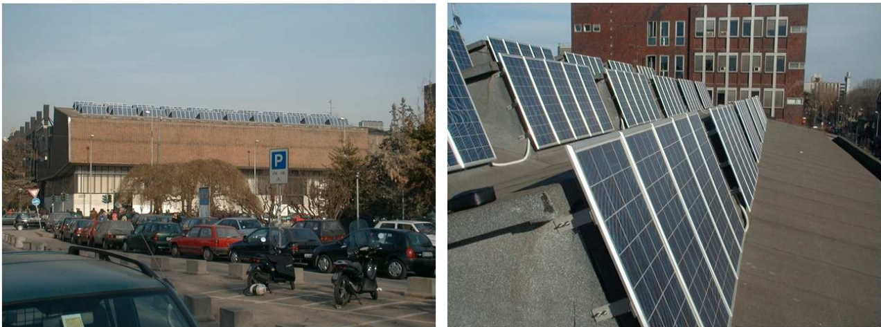
FIG. 33 IMPIANTO FOTOVOLTAICO DEL POLITECNICO DI MILANO, PIAZZA LEONARDO DA VINCI, EDIFICIO 11
