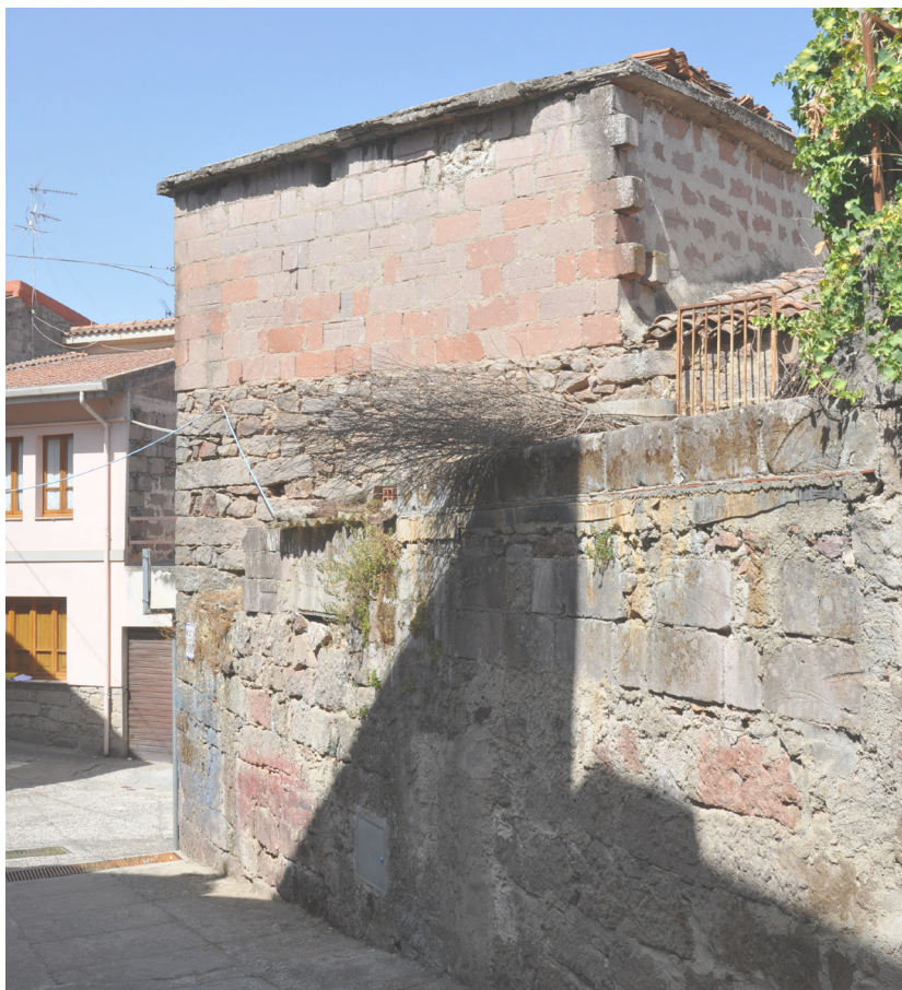
Esempio di intervento improprio Presenza fotografica personale
