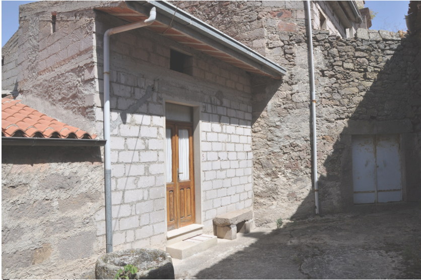
Esempio di intervento improprio
