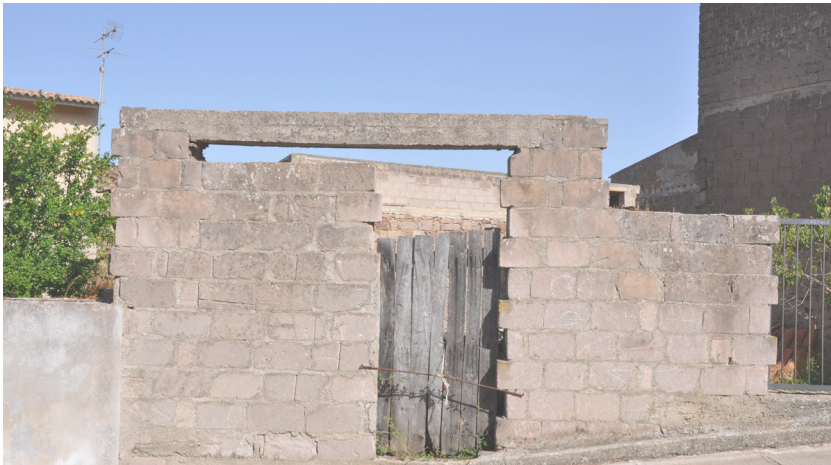
Esempio di intervento improprio Presenza fotografica personale
