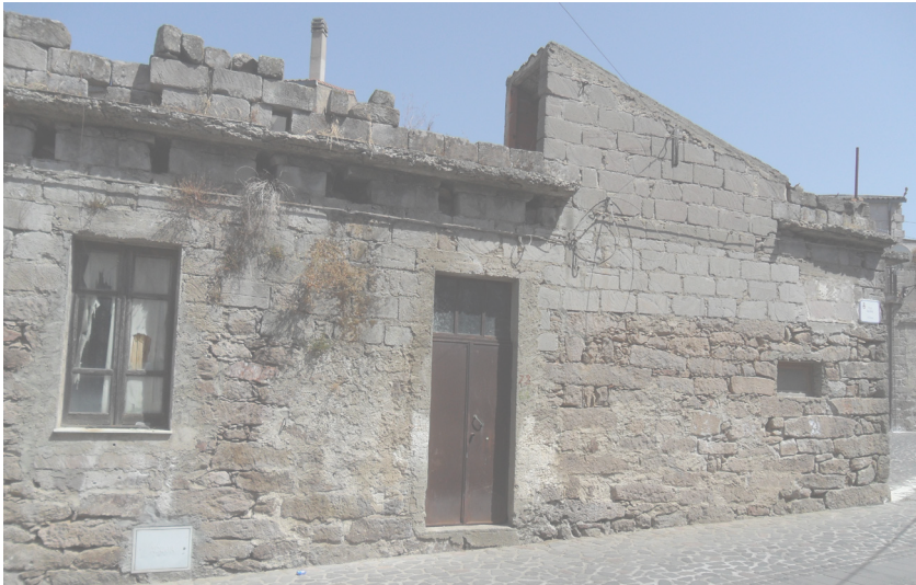
Esempio di intervento improprio
