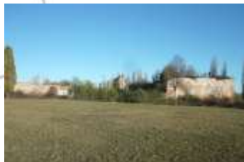
21. Lato Sud della cascina Airale, Torino. Nasceva come granaio, oggi è di proprietà comunale, in completo stato di abbandono e ridotta a rudere
