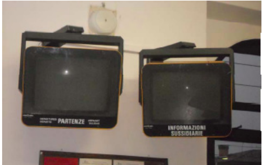
Fig. 2.5 Apparecchiature malfunzionanti, stazione di Piadena (CR)
