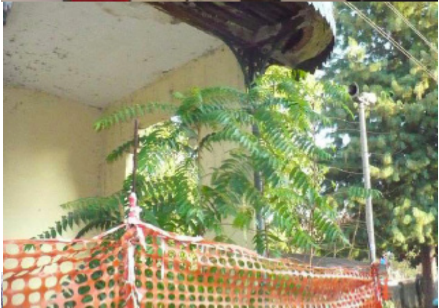
Fig. 2.6 Degrado esterno, stazione di Magenta (MI)
