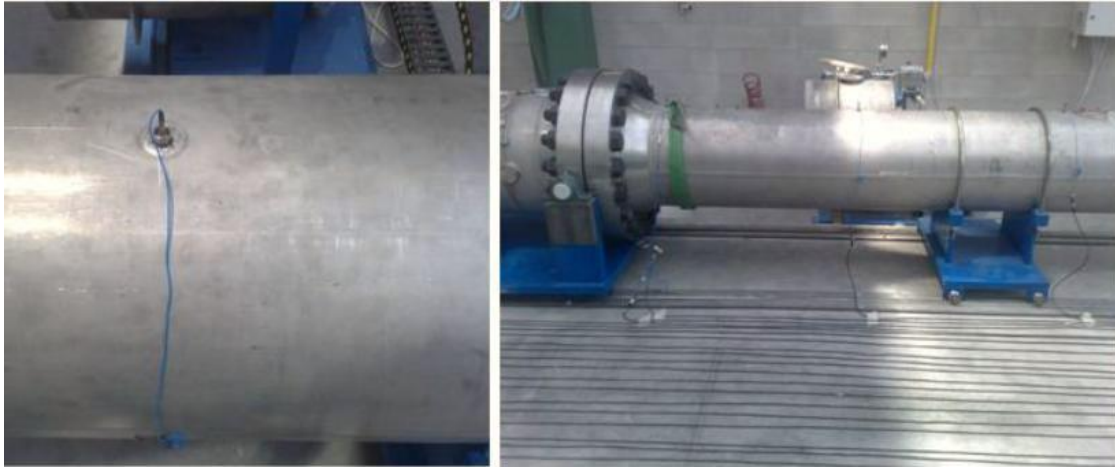
Figura 1.30 - Trasduttori di pressione sulla camera driven
