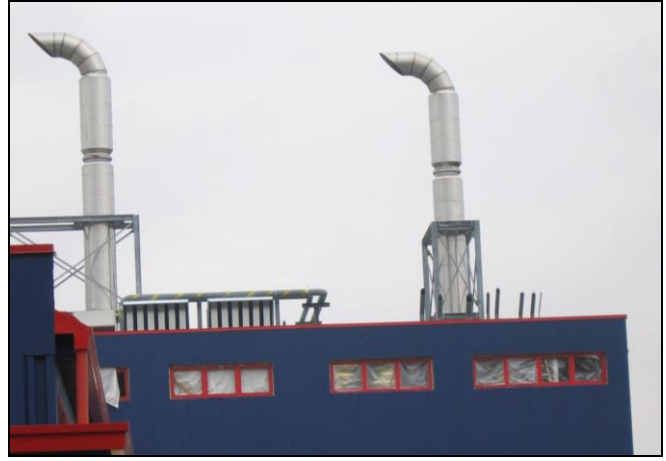
FIGURA 21 – Camini del cogeneratore
