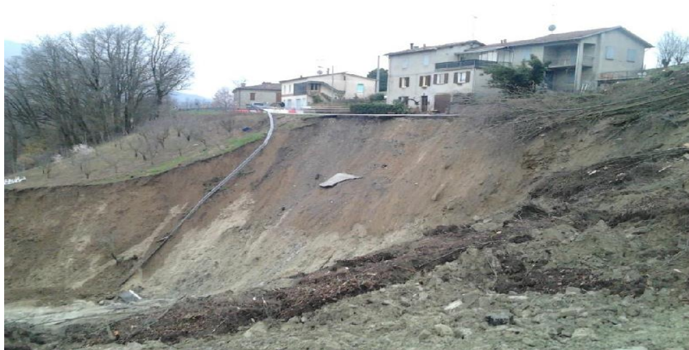
Frana di Tizzano 155
