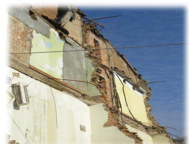
Figura 59_Intera palazzina crollata. Fonte: Sopralluogo del 14/02/2013
