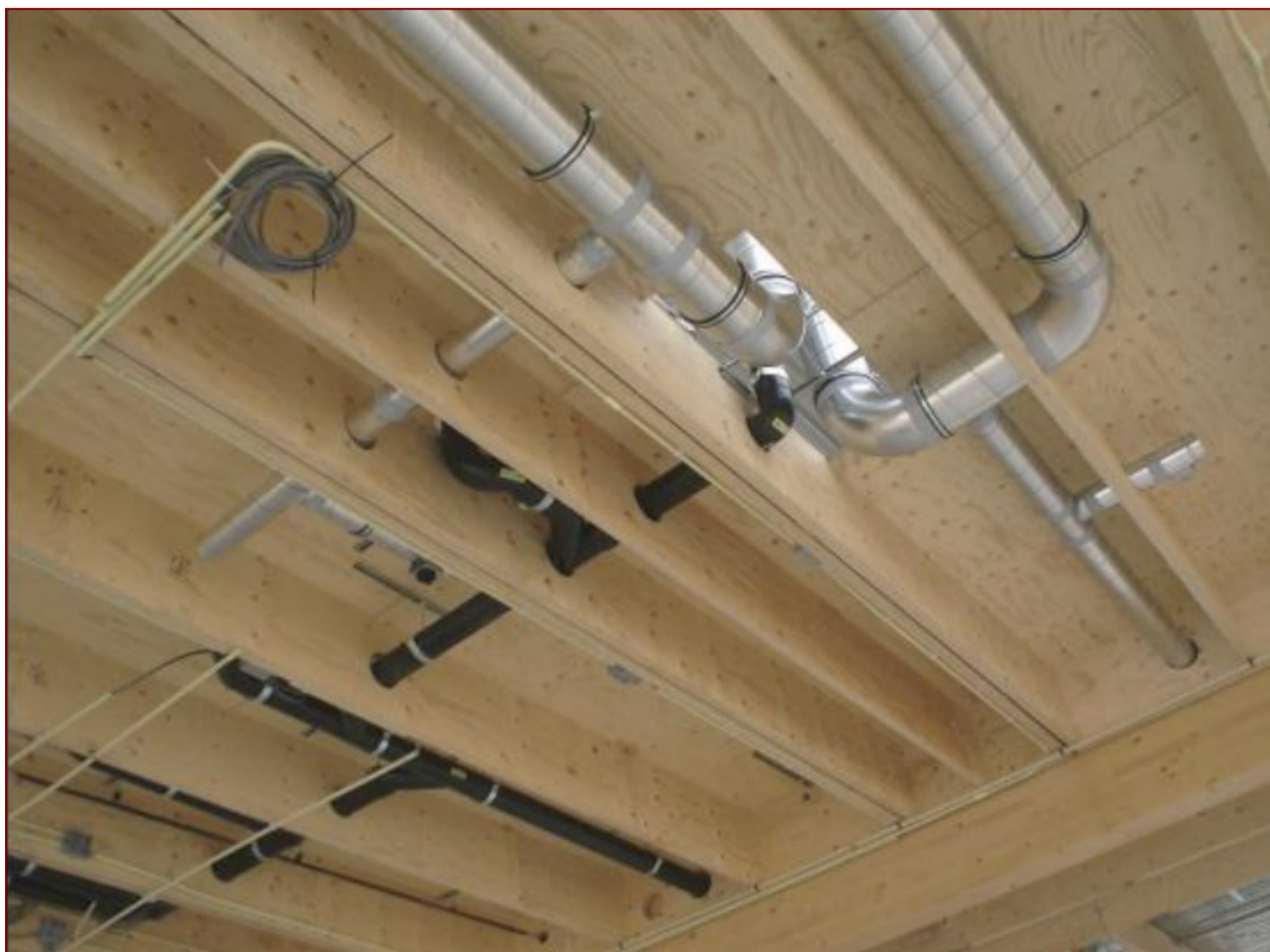
Figura 4.6 - Solaio di Kerto Ripa con degli impianti.
