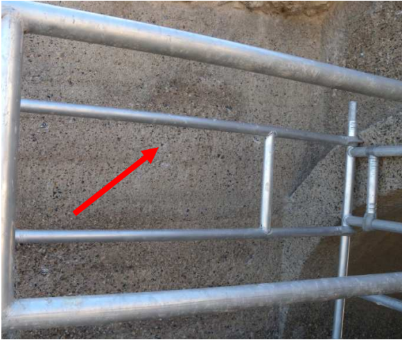
Figura B.17: Indicazione del punto di prelievo del campione 2-VE-2(4) sul muro, lato ovest.
