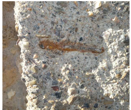
Figura B.15: Particolare corrosione dell'inserito metallico.
