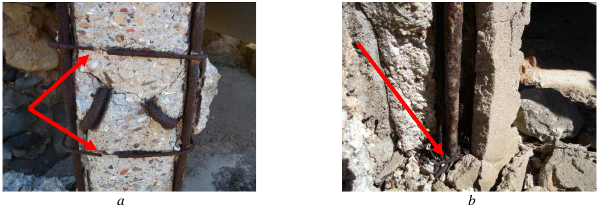
Figura 3.6: Particolare della corrosione delle armature del pilastro C. In rosso sono evidenziati il distacco delle staffe (a) e i frammenti di ossido che derivano dai prodotti di corrosione (b).
