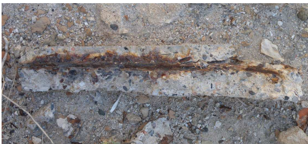
Figura 3.18: Particolare della superficie di distacco di un frammento del corpo nord sul quale sono presenti i prodotti di corrosione lasciati dall'armatura.
