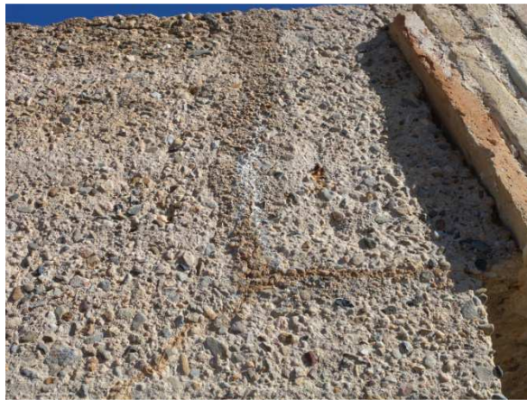
Figura B.27: Particolare delle efflorescenze bianche presenti sulla superficie del calcestruzzo, a : nel lato sud dell'architrave.
