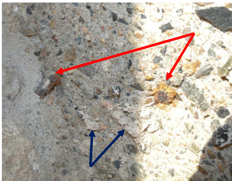
Figura 3.13: Particolare della corrosione degli inserti metallici indicati in rosso e delle efflorescenze bianche sulla superficie del calcestruzzo indicate in blu.
