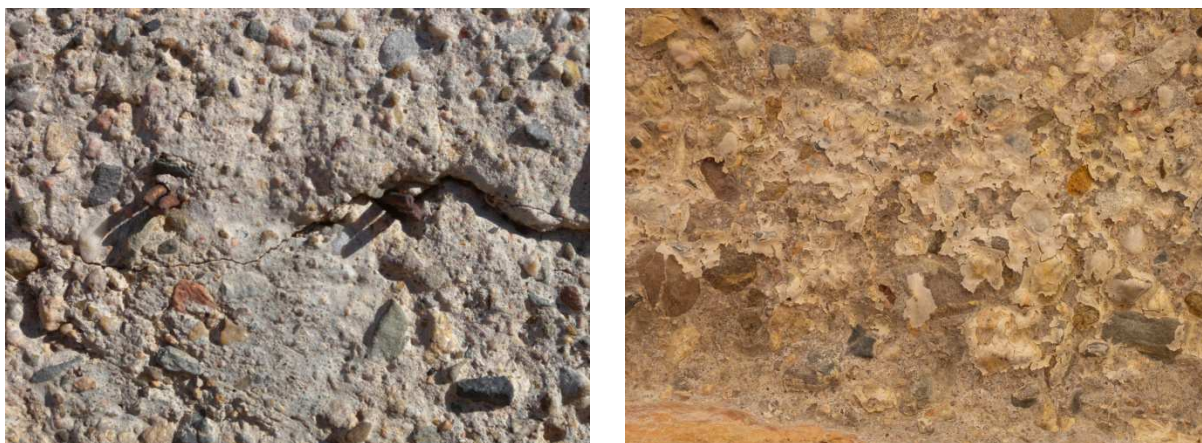
a b Figura 3.15: a : Particolare degli inserti metallici che fuoriescono dalla superficie del calcestruzzo; b : particolare delle efflorescenze bianche presenti sulla superficie del calcestruzzo nell'intradosso dell'architrave
