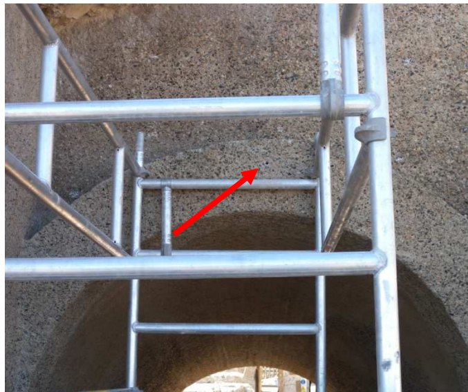
Figura B.16: Indicazione del punto di prelievo del campione 2-VE-1(4) sulla volta, lato nord.
