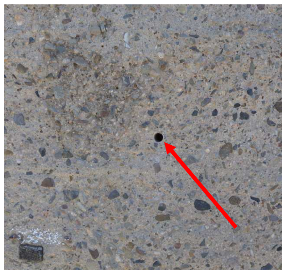
Figura B.29: Indicazione del punto di prelievo del campione 3-V-2(4) sul muro, lato nord.
