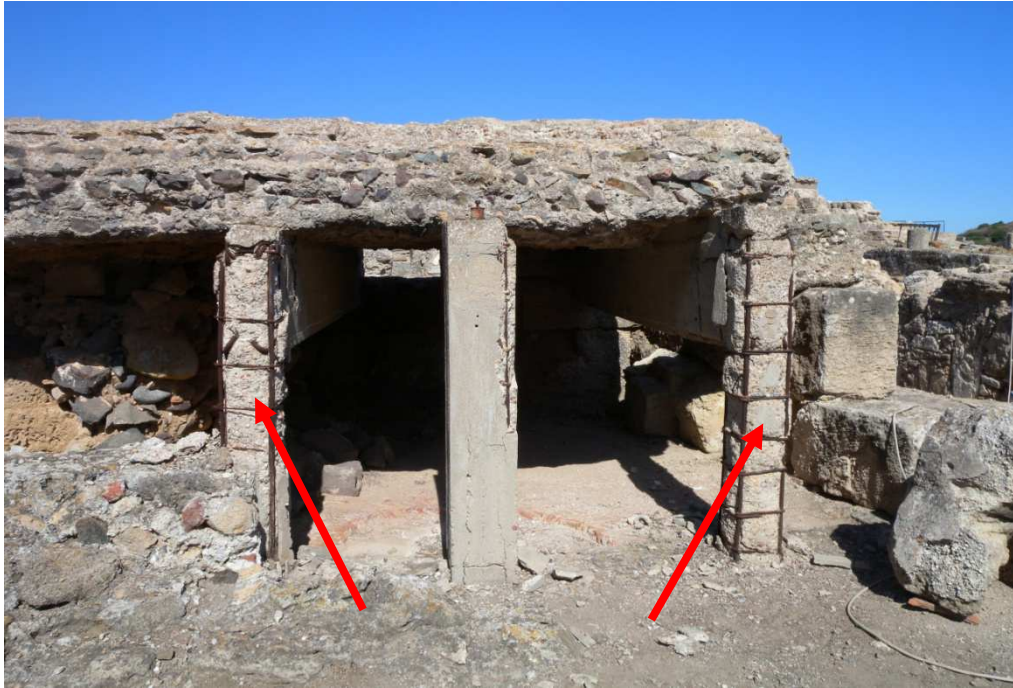
Figura 3.4: Vista sud-ovest dei pilastri A, B e C (partendo da destra) della zona 1- terme centrali . In rosso sono evidenziati i pilastri A e C caratterizzati dalla mancanza del copriferro.
