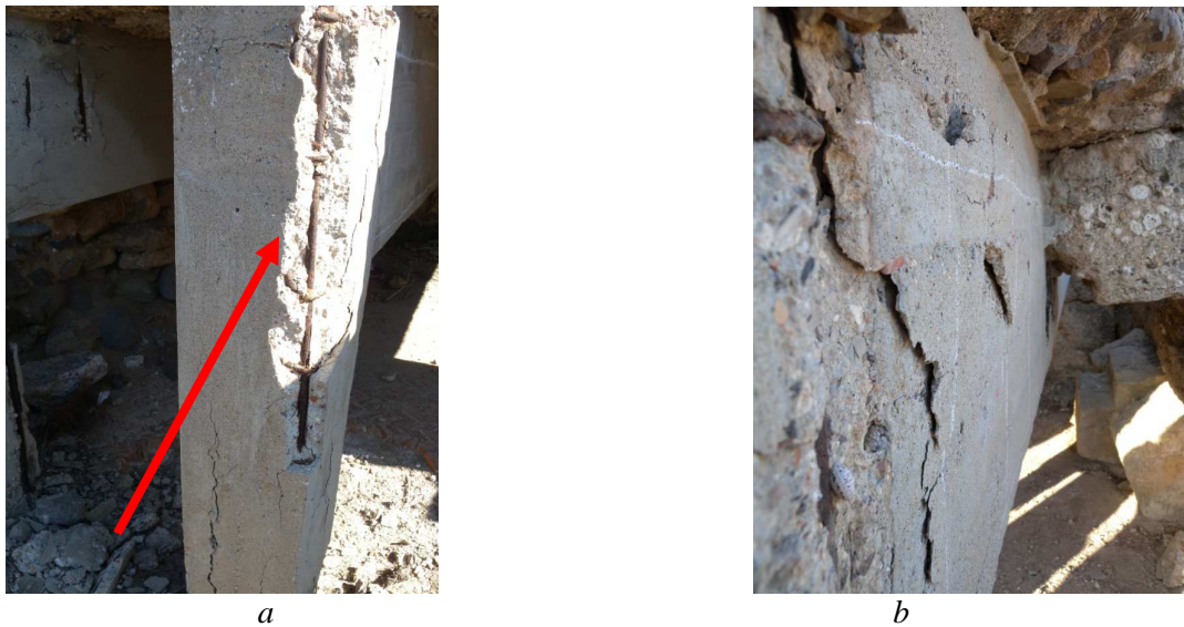
Figura 3.7a: Vista sud del pilastro B, con l'indicazione del distacco del copriferro; b: Particolare della superficie di distacco del copriferro della trave A lato sud-est.
