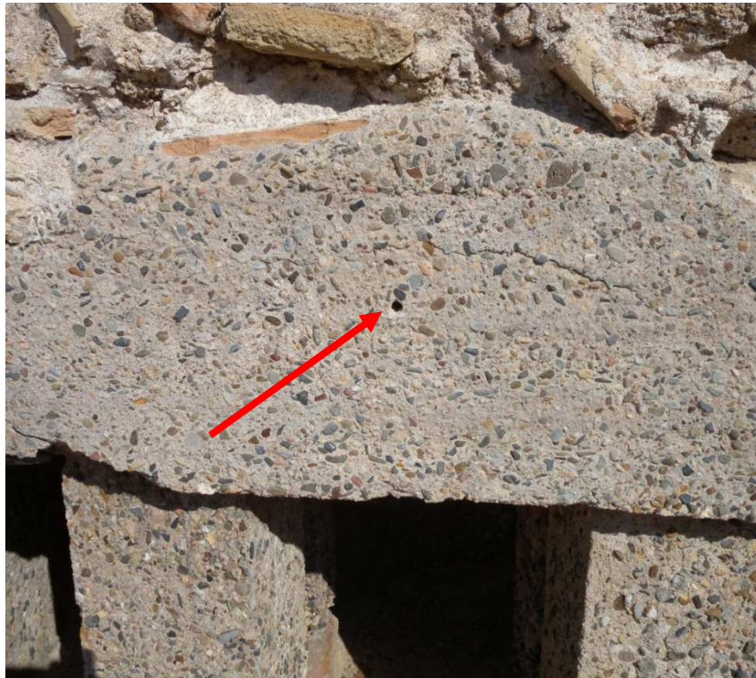
Figura B.35: Indicazione del punto di prelievo del campione 4-TE-1(4) sullo spessore della soletta del corpo est, lato ovest.
