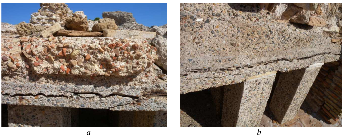
Figura 3.17: Particolare delle fessure presenti nella soletta del corpo nord (a) e del corpo est (b).
