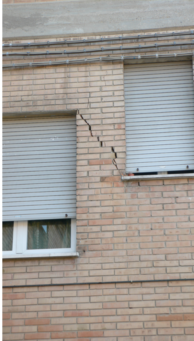
20 Fotografia ritraente le lesioni subite dai tamponamenti in faccia-vista del condominio
