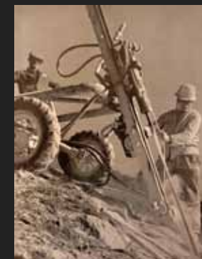
Miniera di Alpetto. Dumpers e wagon-drills al lavoro nel sito di estrazione
