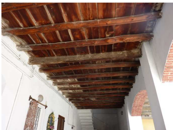
Fig. 170 - Le travi di Via Trento
