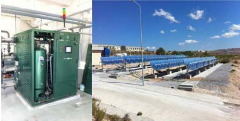
Figura 4.2 Impianto ORC alimentato da un campo solare a Cipro
