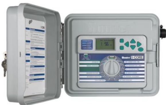
Figura 4-25 Centralina di controllo per l'impianto di irrigazione
