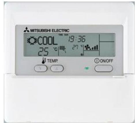
Figura 4-24 Pannello di controllo del sistema di condizionamento
