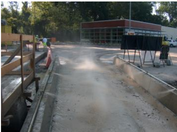
Figura 5-11 Sistema automatizzato di lavaggio ruote
