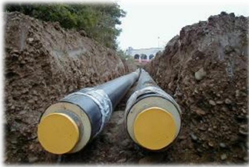
Figura 2.6 - Tubazioni di una rete di teleriscaldamento a sistema chiuso
