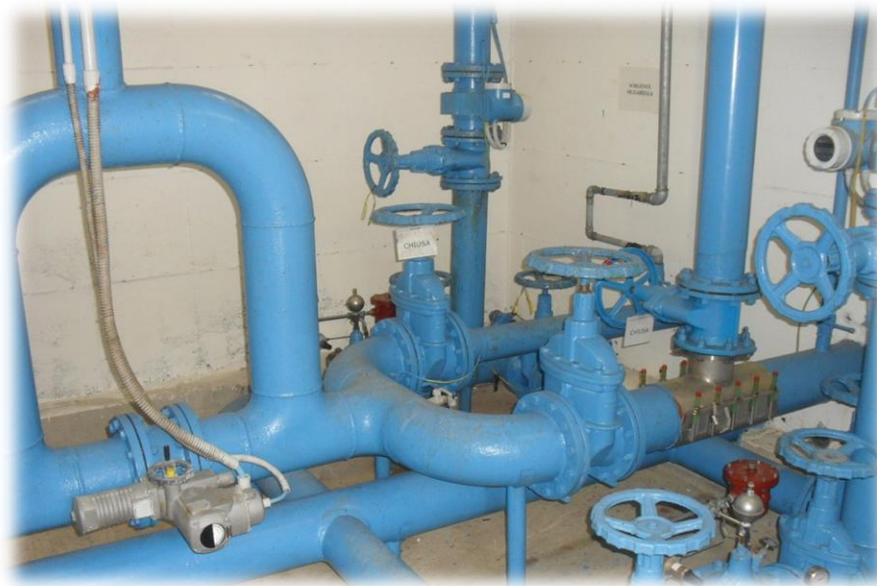
Figura 2.2 - Tubazioni di acquedotto
