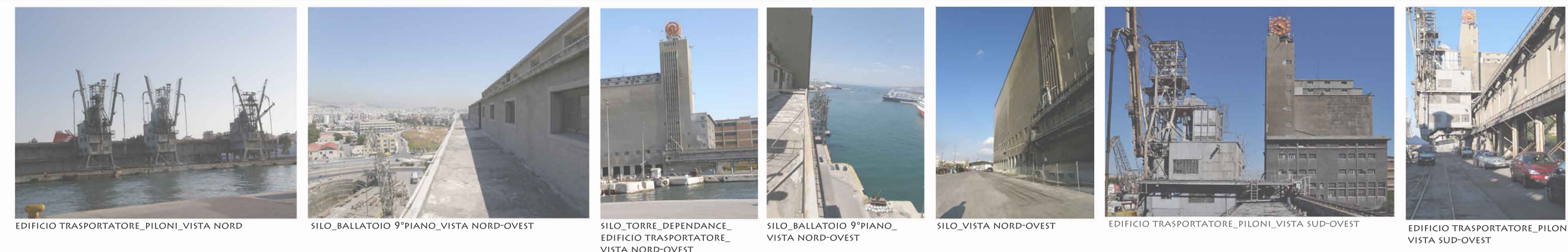
EDIFICIO TRASPORTATORE_PILONI_VISTA NORD, SILO_BALLATOIO 9°PIANO_VISTA NORD-OVEST, SILO_TORRE_DEPENDANCE_EDIFICIO TRASPORTATORE_VISTA NORD-OVEST, SILO_BALLATOIO 9°PIANO_VISTA NORD-OVEST, SILO_VISTA NORD-OVEST, EDIFICIO TRASPORTATORE_PILONI_VISTA SUD-OVEST, EDIFICIO TRASPORTATORE_PILONI_VISTA SUD-OVEST
