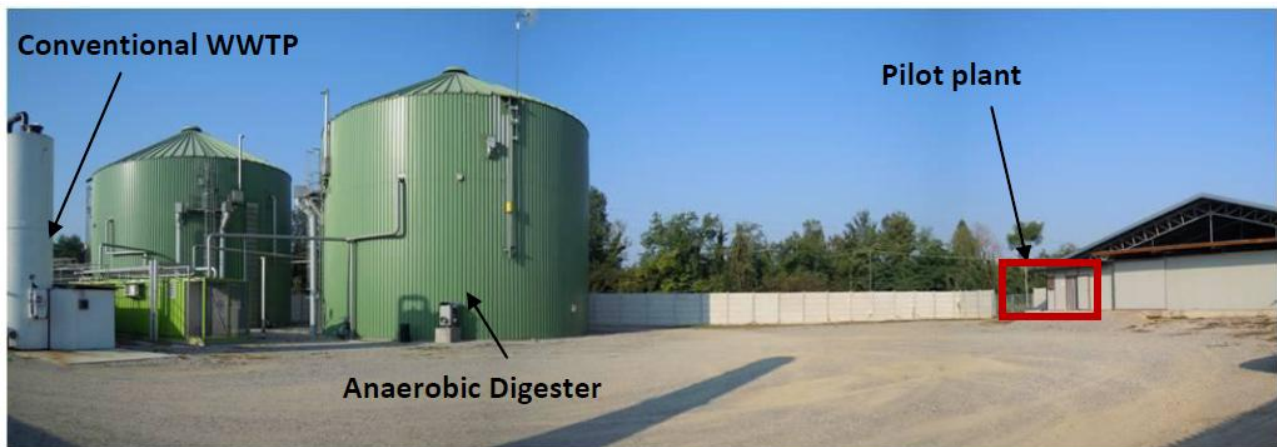
Figura 1.4 Particolare dell'impianto e localizzazione della sezione pilota
