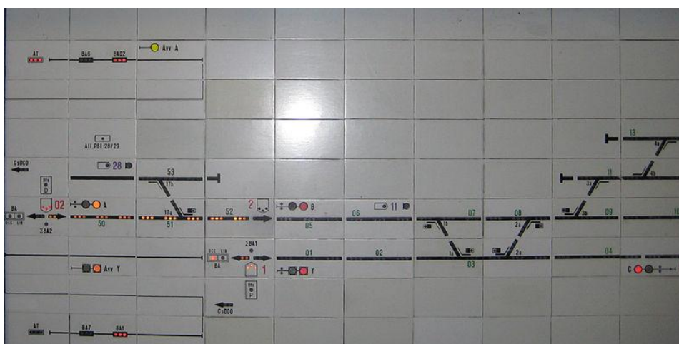
Figura 4-28: Particolare di un impianto ACEI: il quadro luminoso.
