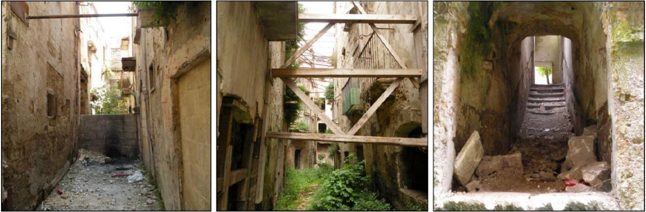
Figura 64 - A sinistra: muro di sbarramento che impedisce l'entrata in Via di Mezzo dalla chiesa dei Santi Medici; al centro: edifici pericolanti puntellati lungo posti lungo Via di Mezzo; a destra: rampa di accesso al primo piano di un edificio con i solai crollati 179 .
