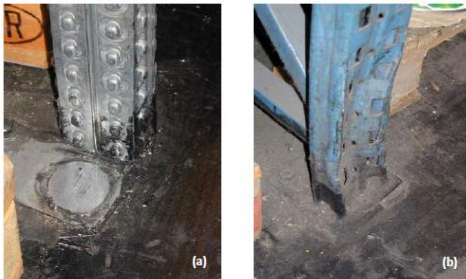
Figura 6.2.1.4 (a) Tranciamento montante dopo l'urto (b) deformazione montante dopo l'urto
