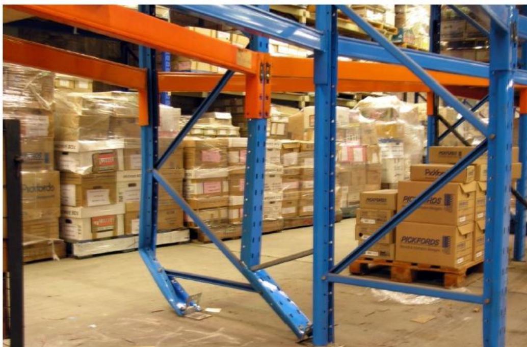
Figura 2.5.1 Montanti affetti da deformazioni plastiche
