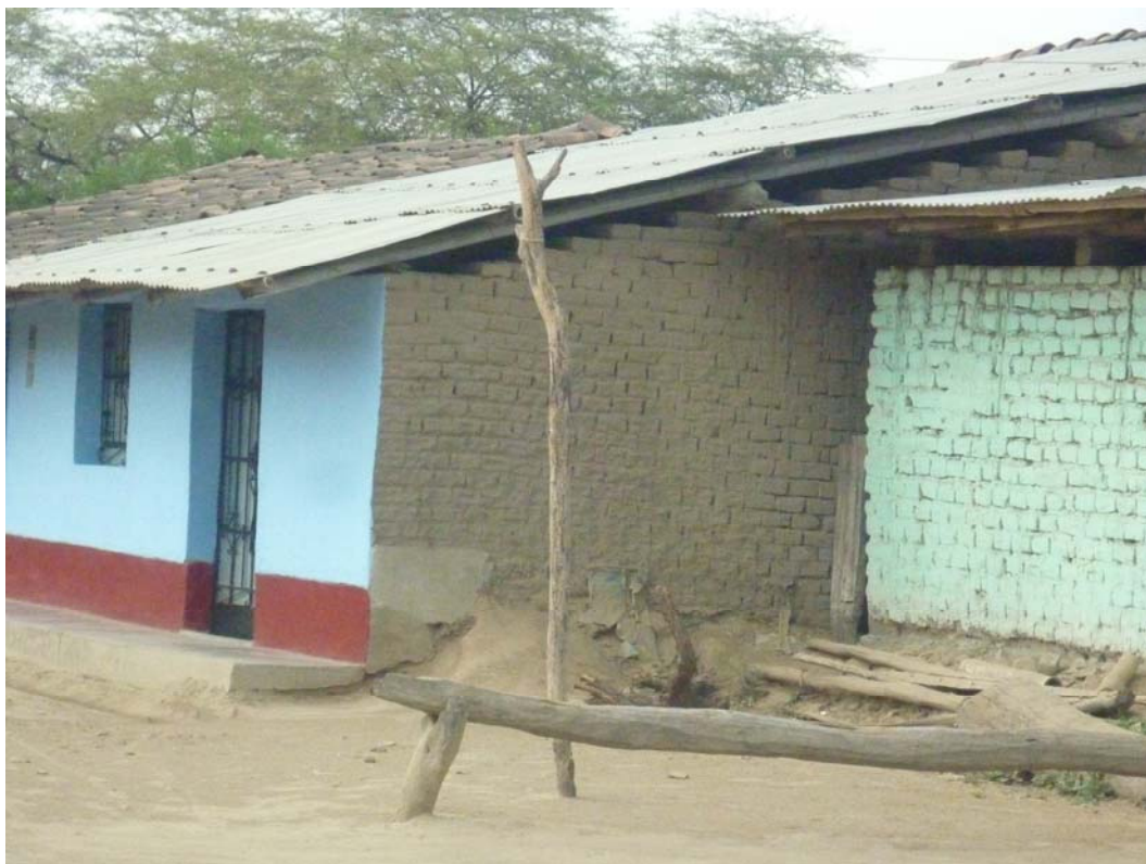
Figura 4.24 Muratura crescente verso l'interno della casa per accompagnare l'inclinazione del tetto, in lamiera.
