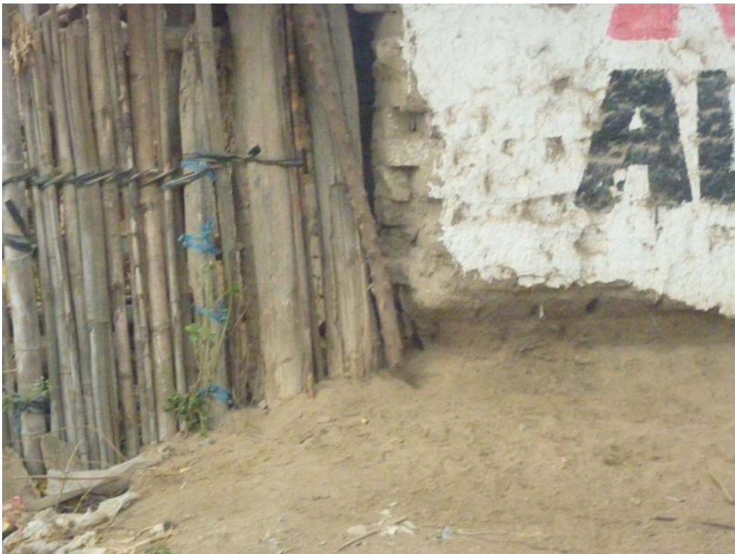
Figura 4.12 Particolare dell'angolo dell'abitazione: erosa alla base e senza cemento.
