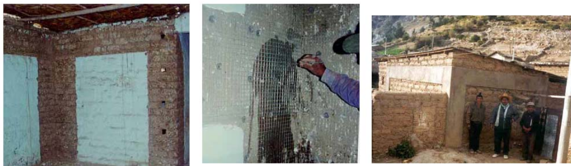
Figura 6.10 Sequenza per il rinforzo di una casa esistente: si rimuove l'intonaco esistente e si fora il muro, si posa la mesh di fili metallici e i connettori che passano nei muri e infine si ricopre di malta.
