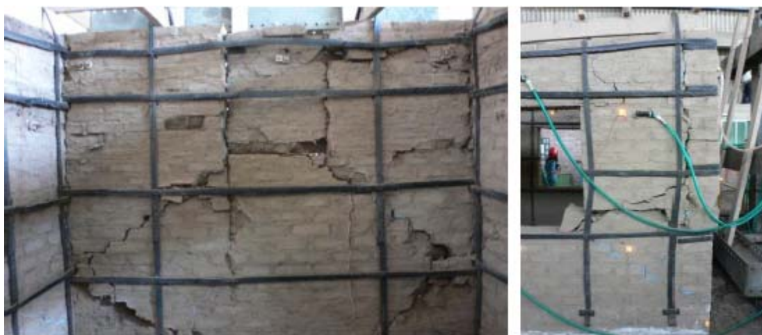
Figura 7.54 A sinistra il danno del muro del retro dopo la fase 3, a destra il pilastro più danneggiato.
