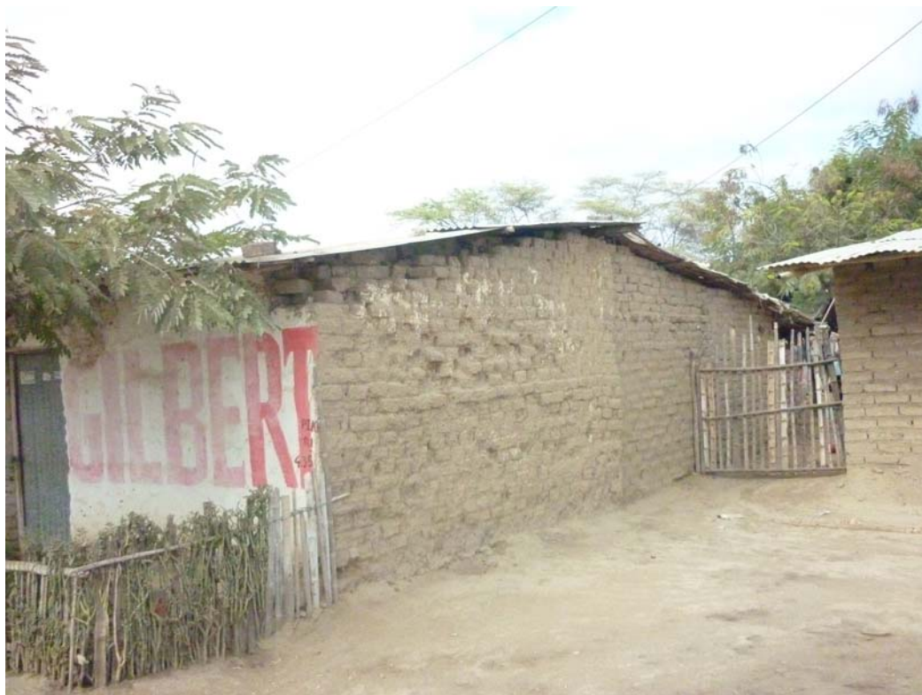
Figura 4.13 Muro senza sovralfondazione di cemento, con palesi problemi di allineamento e omogeneità della muratura.
