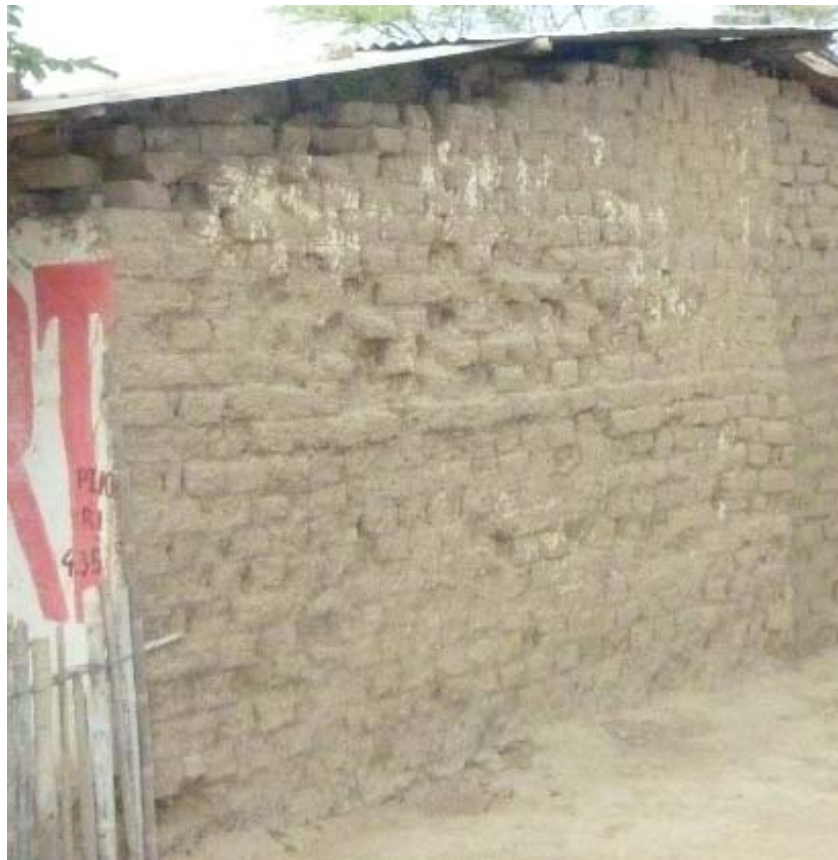
Figura 4.17 Casa di Piura la Vieja: scarsa omogeneità e qualità della muratura, con mattoni sfalsati che rientrano o sporgono.
