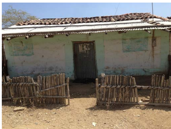
Figura 4.32 Casa tipica in Adobe: senza fondazioni in calcestruzzo, con tetto irregolare, non ben fissato, in canne e lamiera o tegole, muri di scarsa qualità (a volte intonacati per pubblicità).
