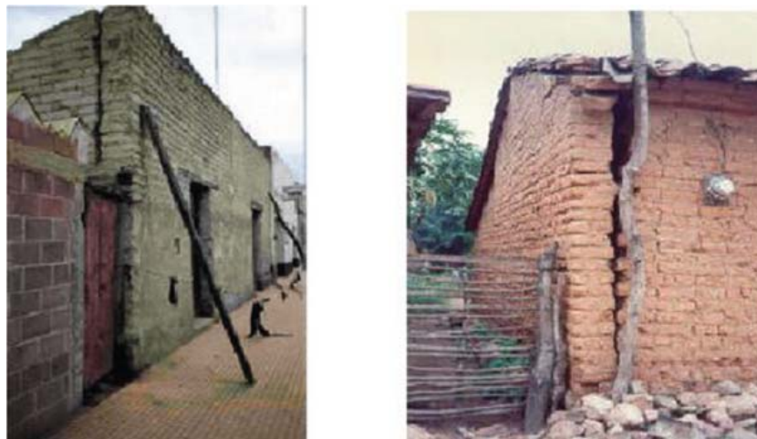
Figura 5.6 Fessure verticali causate da sollecitazioni fuori piano (Messico).
