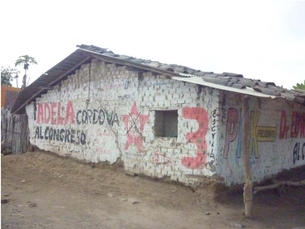
Figura 4.11 Erosione più evidente alla base del muro, senza fondazioni in calcestruzzo.
