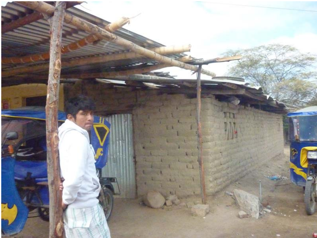
Figura 4.10 Casa sulla strada per Chulucanas: senza cordolo di calcestruzzo alla base e con un principio di erosione al piede dei muri.
