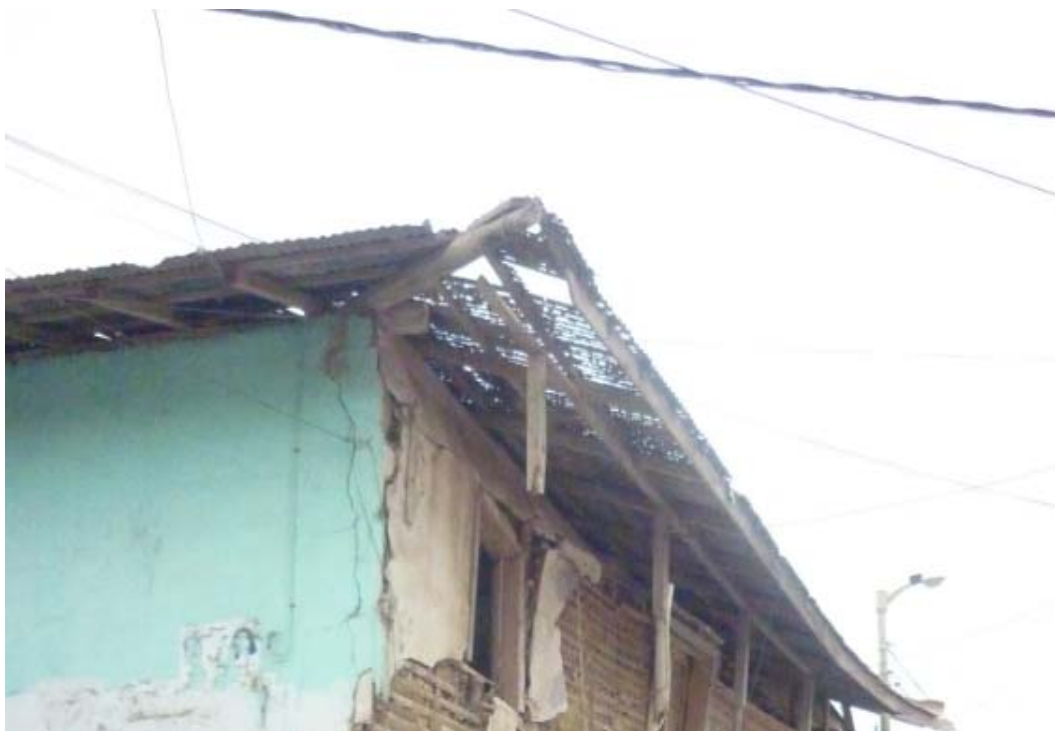
Figura 4.23 Tetto in canne schiacciate in cattive condizioni, Paita.
