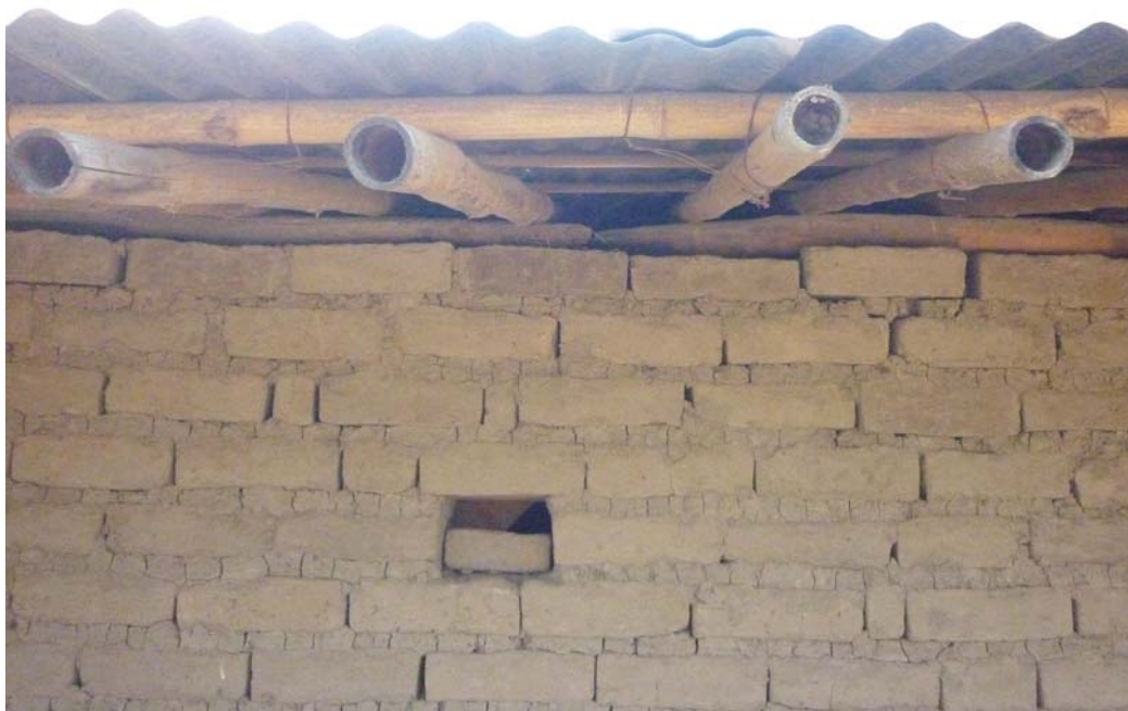
Figura 4.14 Mancanza di corretto allineamento dei mattoni, che non si sovrappongono con le estremità della fila sotto in corrispondenza della mezzeria dei mattoni della fila sopra.
