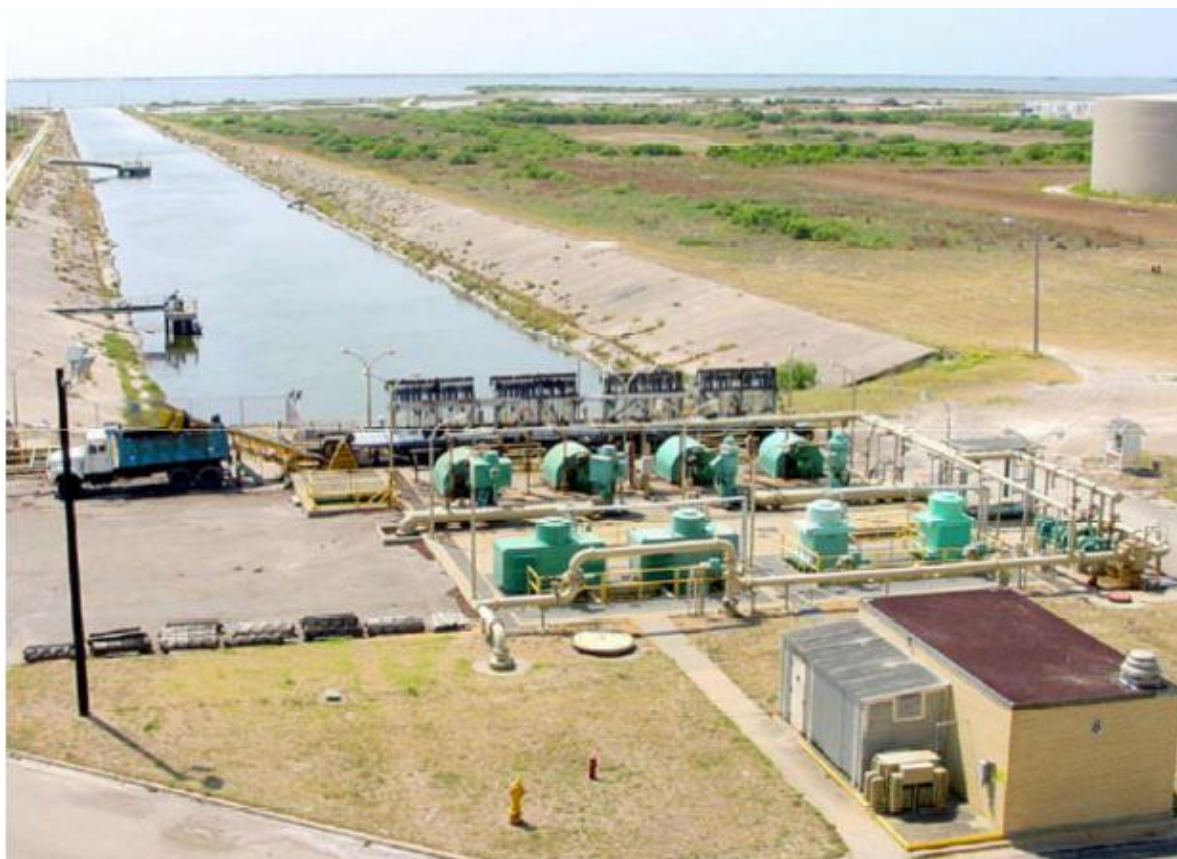
Figura 5.3.2 – Immagine raffigurante la parte terminale di un canale di intake diretto superficiale (T. Pankratz, 2008).
