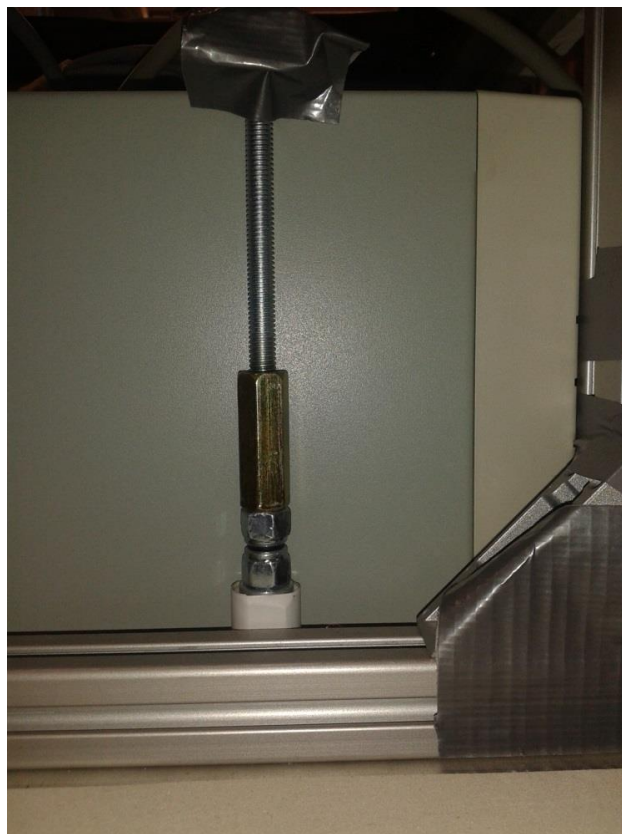
Figura 2-25 Particolare sistema di fissaggio utilizzato per power supply e data logger
