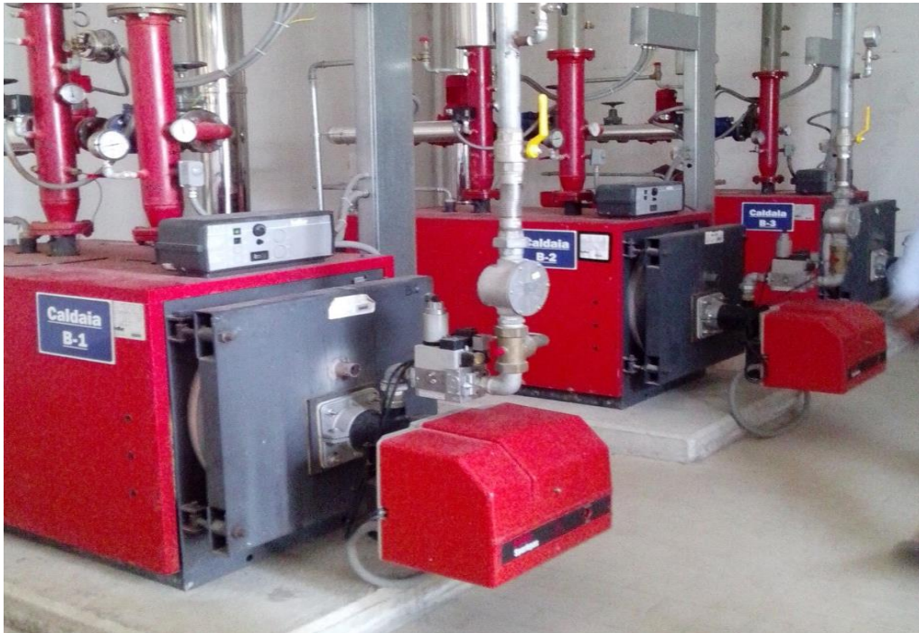
Figura 2.6 Le tre caldaie Baltur 330.
