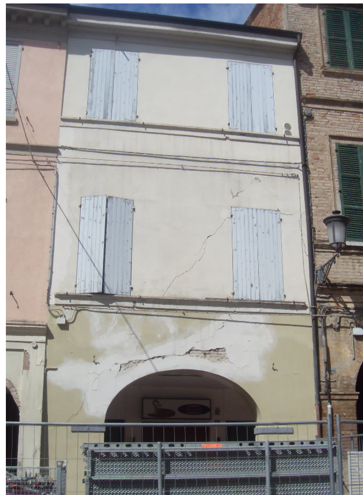
FIG. 24. COLLASSO NEL PIANO DI UN EDIFICIO A MIRANDOLA DOPO IL RECENTE SISMA CHE HA COLPITO L'EMILIA
