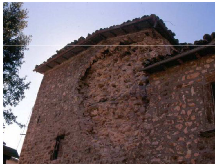
FIG. 17. ESEMPIO DI DISGREGAZIONE DELLA MURATURA
