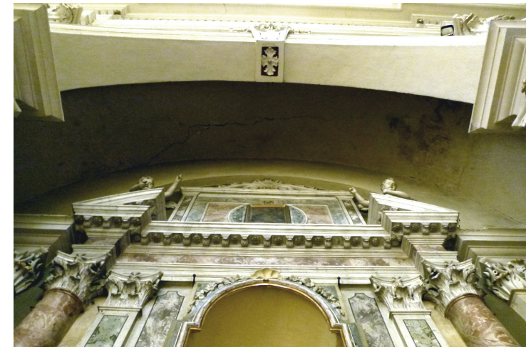
FIG. 95. LESIONI SULLE VOLTE DELLE CAPPELLE LATERALI
