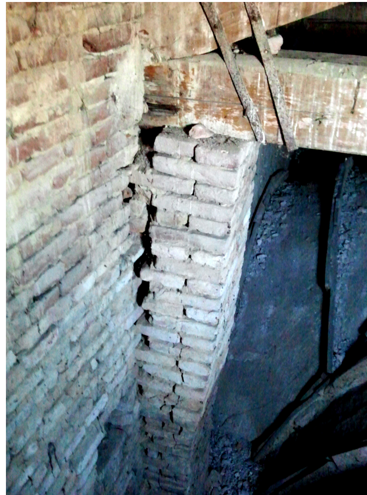
FIG. 93. SFILAMENTO DALLA MURATURA PERIMETRALE DEL PILASTRO DI DESTRA CHE SOSTIENE L’ULTIMA CAPRIATA
