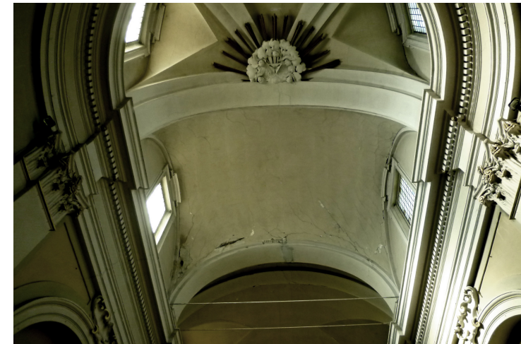
FIG. 94. LESIONI SULLA VOLTA A VELA DELL’ABSIDE
