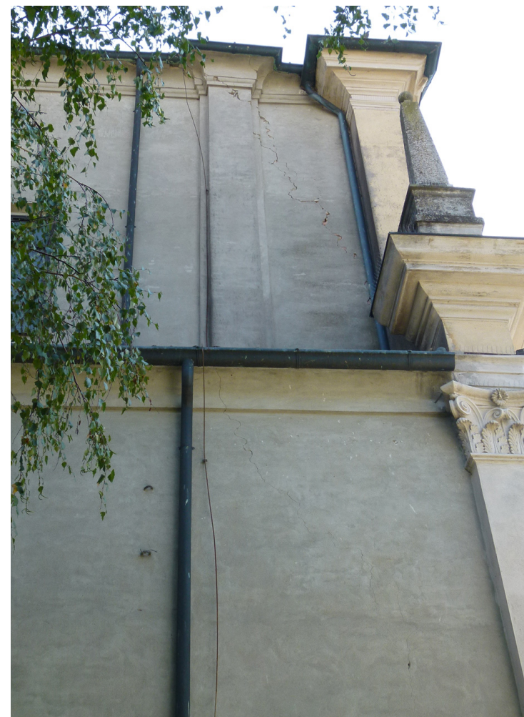
FIG. 92. LESIONI SULLE PARETI LATERALI IN CORRISPONDENZA DELL'INNESTO DELLA FACCIATA
