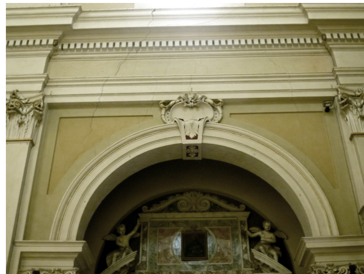
FIG. 91. LESIONI ALLA PARETE LATERALE LA NAVATA, CHE DA LA FINESTRA SOVRASTANTE ARRIVA FINO ALL'ARCO DI SCARICO SOTTOSTANTE
