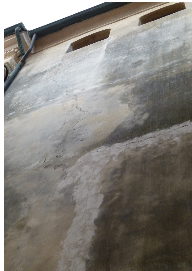
FIG. 112. LESIONI DI INTONACO SULLE PARETI ESTERNE LATERALI
