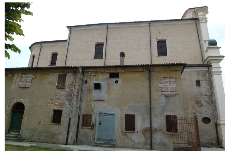
FOTO. 128. LESIONI SULLE PARETI LATERALI
