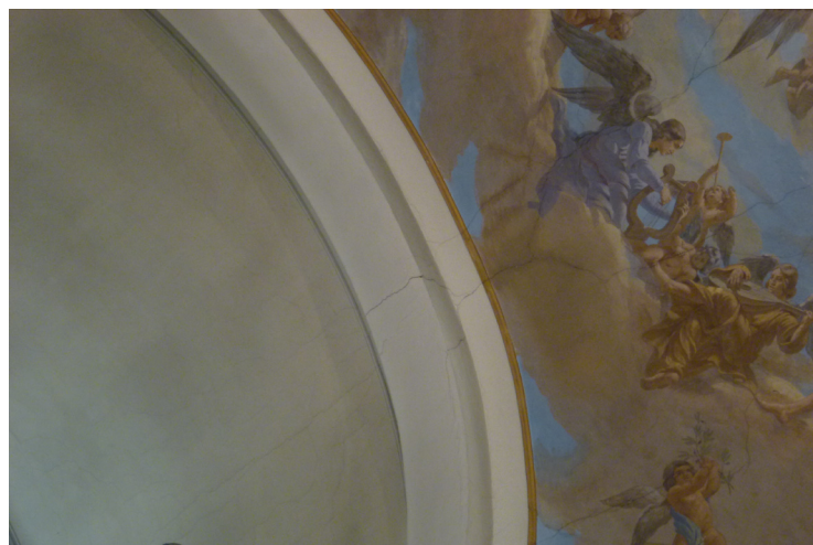
FIG. 111. LESIONI DI INTONACO SULLA VOLTA DIPINTA A TEMPERA
