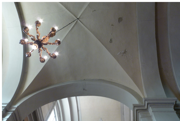
FIG. 110. LESIONI DI INTONACO SULLA VOLTA A CROCIERA
