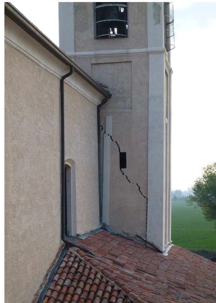
FIG. 126. LESIONI SUL CAMPANILE
