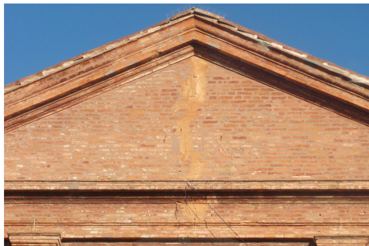
FIG. 143. LESIONE VERTICALE SUL TIMPANO DELLA FACCIATA
