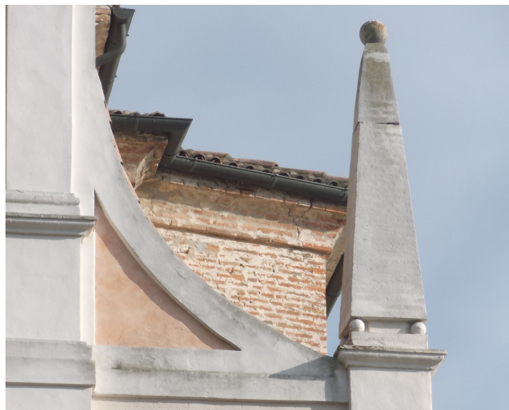
FIG. 161. LESIONI AI PINNACOLI DELLA FACCIATA
