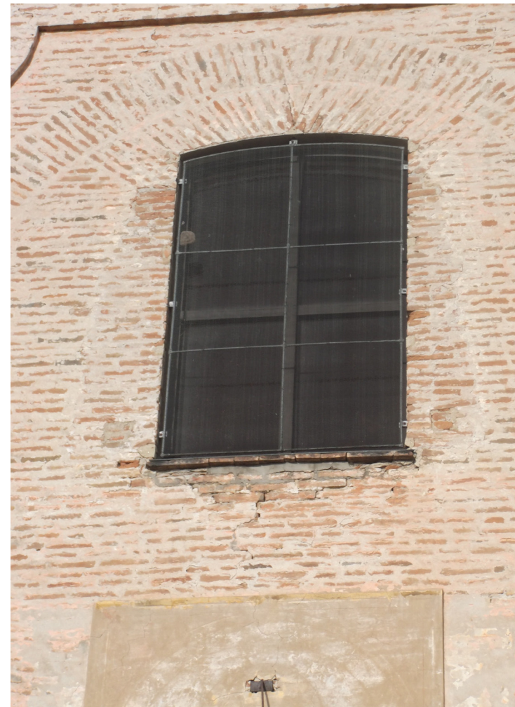
FIG. 160. PARTICOLARE DELLE LESIONI IN CORRISPONDENZA DELLE APERTURE SULLE MURATURE LONGITUDINALI
