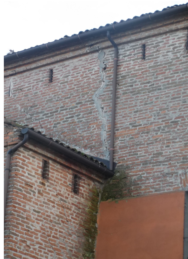
FIG. 141. LESIONE SUL MURO LONGITUDINALE DELLA CHIESA NEL PUNTO DI ADIACENZA CON UN CORPO SECONDARIO
