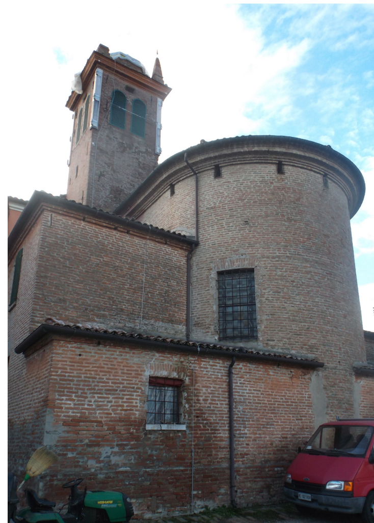
FIG. 145. VEDUTA DEL CAMPANILE DOPO IL CROLLO DELLA COPERTURA
