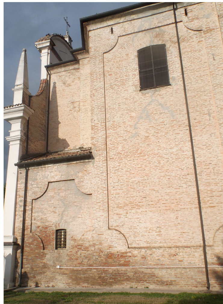
FIG. 162. LESIONI IN CORRISPONDENZA DELLE APERTURE SULLE MURATURE LONGITUDINALI
