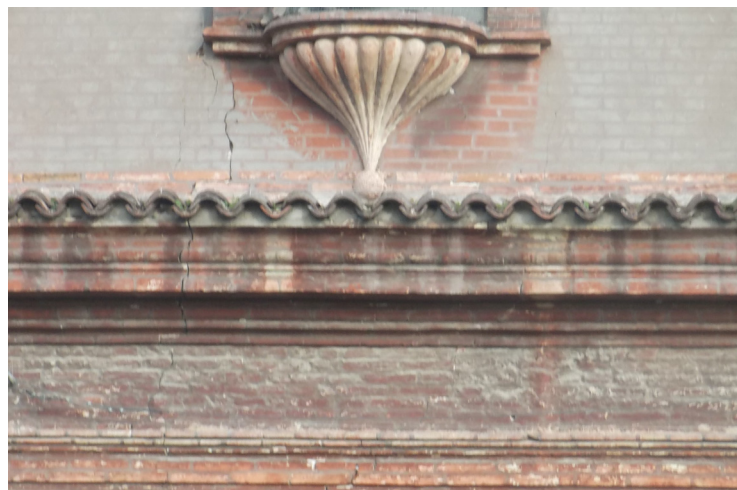
FOTO. 144. LESIONE VERTICALE IN FACCIATA CHE SCENDE SOTTO LA NICCHIA
