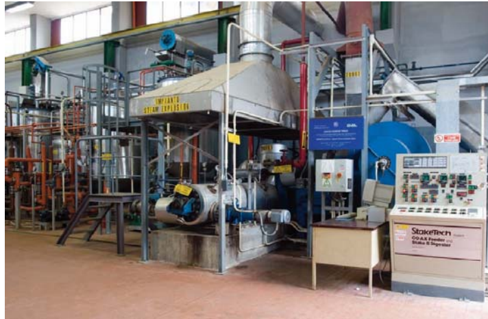
Figura 3.8 - Apparati di alimentazione della biomassa (a destra) e reattore tubolare di Steam Explosion (al centro dell'immagine). Impianto pilota Enea; referente progetto Francesco Zimbardi
