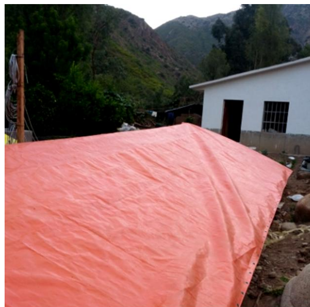
Figura 4.8 Copertura del primo digestore con un telo di nylon
