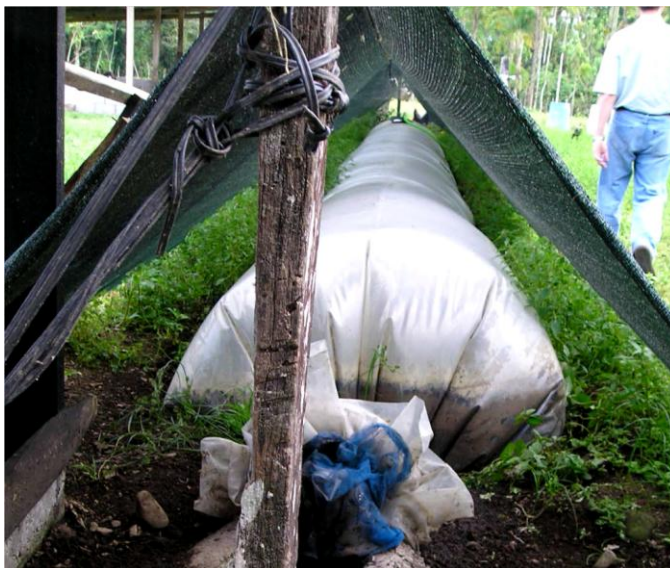
Figura 2.32 Visione esterna della serra in cui viene spesso collocato digestore tubolare.
