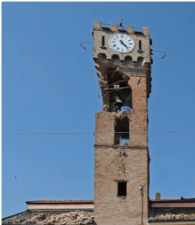
143_Torre Civica subito dopo il sisma, ora è stata completamente abbattuta.
