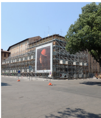
129_Castello dei Pico, dopo il terremoto, messo in sicurezza.
