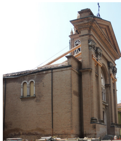
112_Chiesa parrocchiale di S.Egidio Abate gravemente danneggiata dal sisma.
