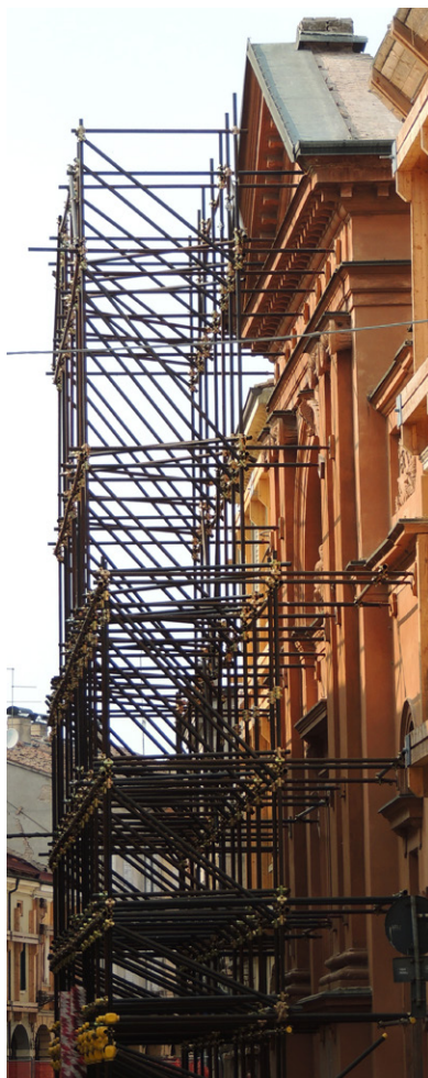
121_Chiesa di San Paolo, messa in sicurezza ma in zona ancora inagibile.
