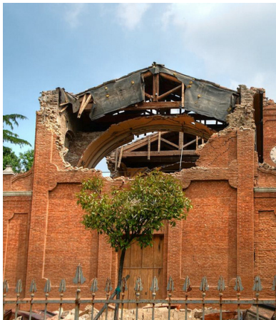
86_Chiesa di Camurana seriamente danneggiata.
