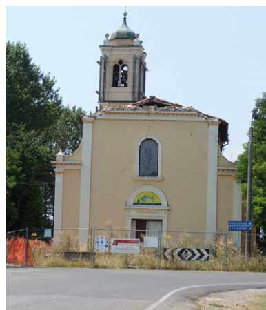
137_Chiesa di San Martino Carano dopo il terremoto.
