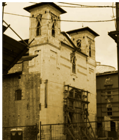
75_ Chiesa di San Marco dopo 4 anni dal sisma.
