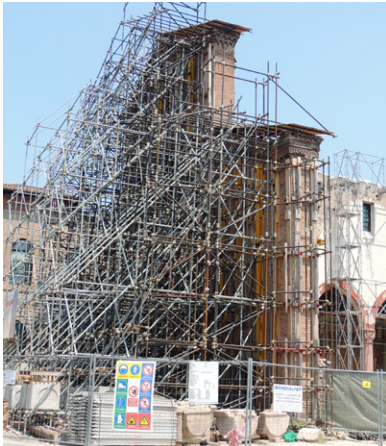
134_ Chiesa di San Francesco d'Assisi dopo il terremoto.
