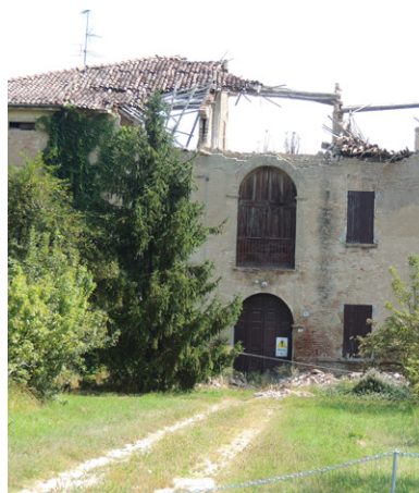
114_Casa Motta gravemente danneggiata dopo il sisma.
