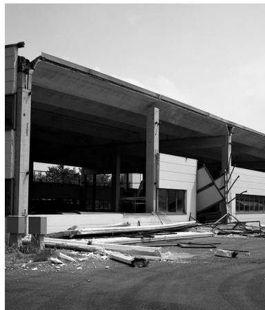
88_ Capannoni NUOVI danneggiati dal terremoto.
