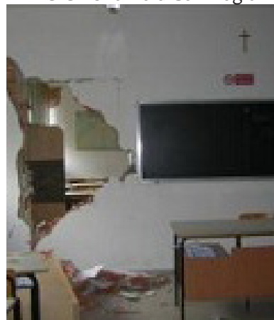
85_ Interno di un'aula scolastica danneggiata dal terremoto.
