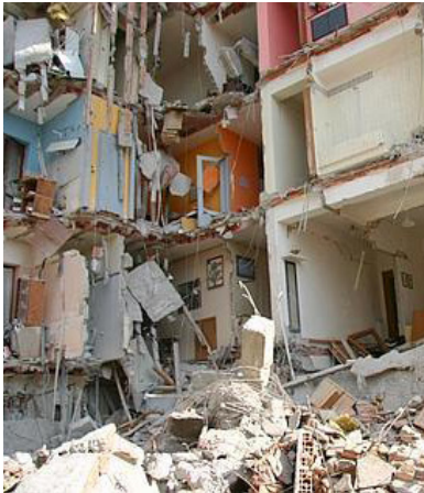
72 Parte della Casa dello Studente crollata. Ha provocato la morte di diversi giovani studenti.
