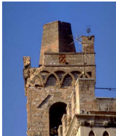
65_ Torre campanile di Foligno danneggiata dal sisma.
