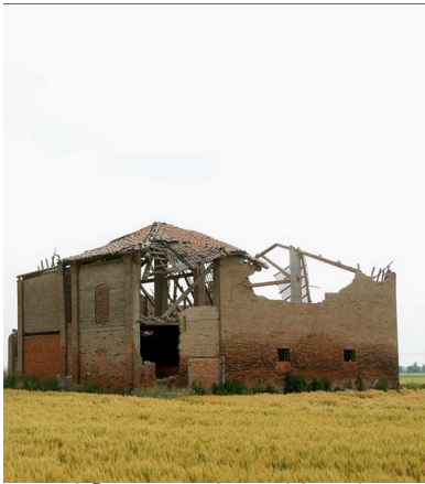
79_Edifici rurali abbandonati crollati a causa delle continue scosse sismiche.
