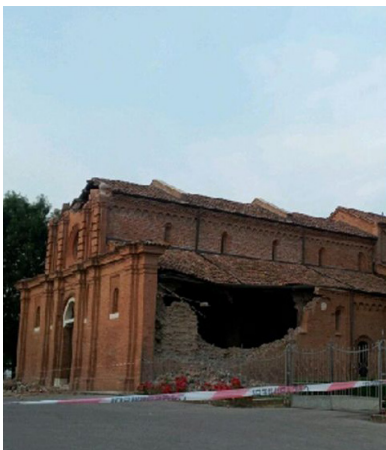
135_ Pieve di Santa Maria della Neve, danneggiata dal terremoto.
