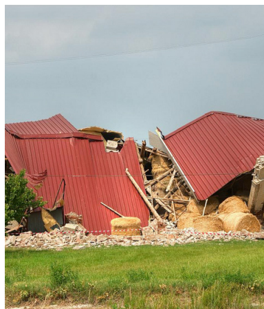
89_ Fienile crollate nelle campagne.
