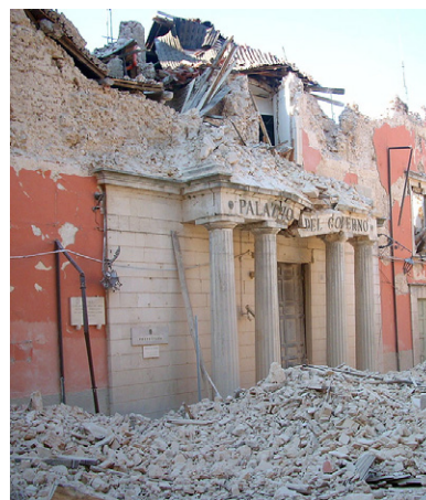
71_ Il palazzo di Giustizia dell'Aquila crollato dopo il terremoto.
