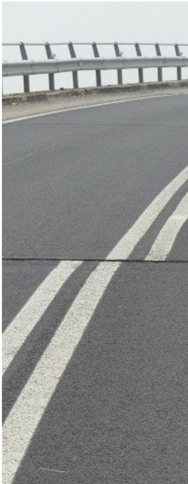
94_La strada si è spostata!
