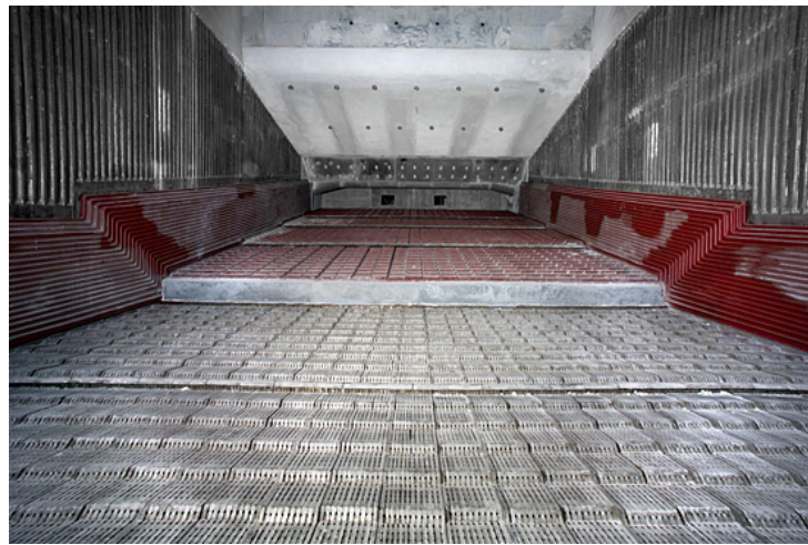
Figura 3.4: Esempio di camera di combustione e griglia raffreddata ad acqua (Babcock & Wilcox Volund)
