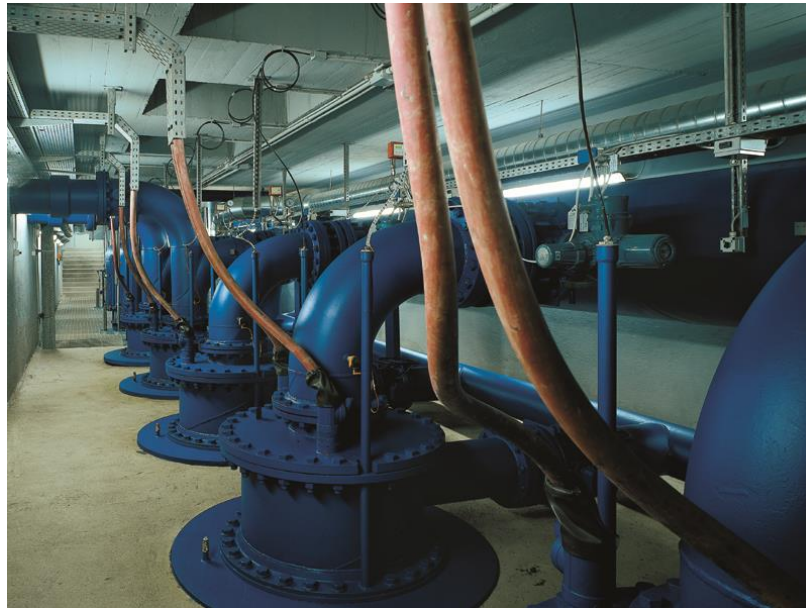
Figura 6.2: Particolare all'interno della stazione di pompaggio "Centrale Lago" dell'Acquedotto Industriale di Como [32]
