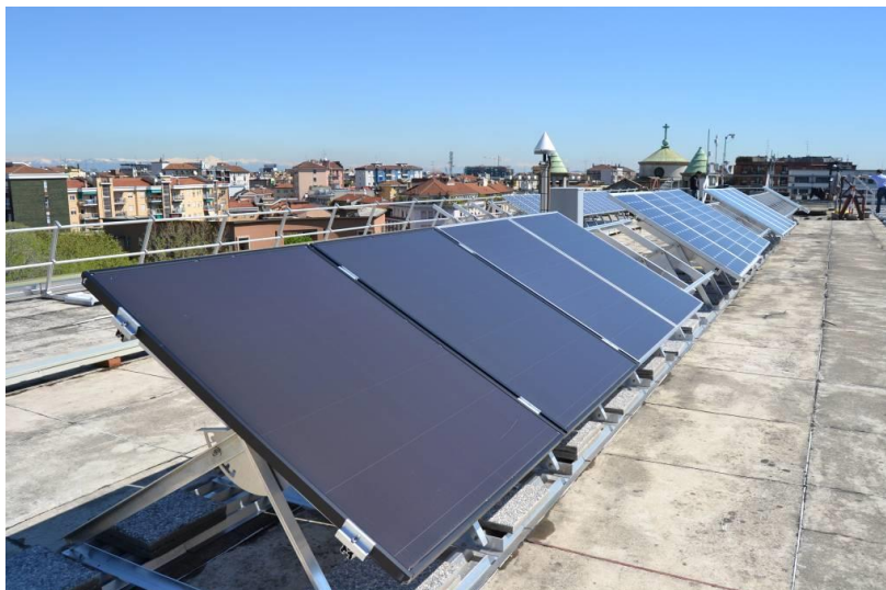
Figura 4.1 – Vista della Test Facility del Politecnico di Milano
