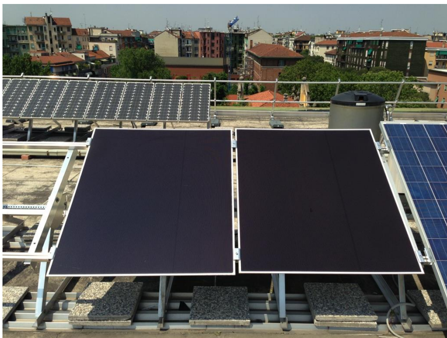
Figura 10.3 – moduli fotovoltaici installati nella test facility
