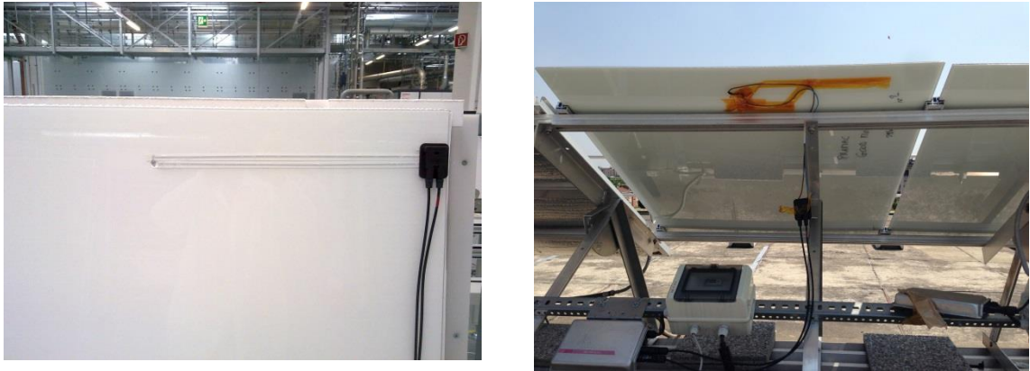
Figura 10.2 – Viste posteriori del modulo fotovoltaico con la scatola di giunzione disancorata
