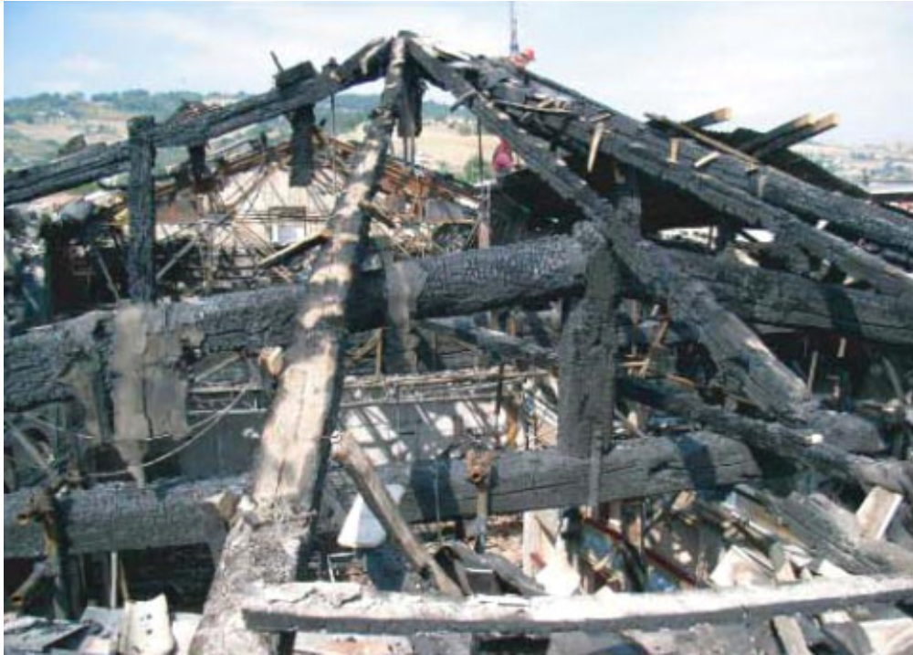
Figura 27 - La copertura distrutta dall'incendio
