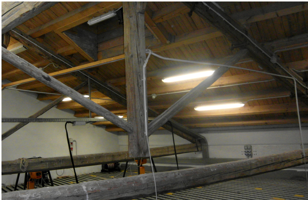
Figura 122 - Capriata esistente, da notare la mancanza di giunzioni tra gli elementi in legno
