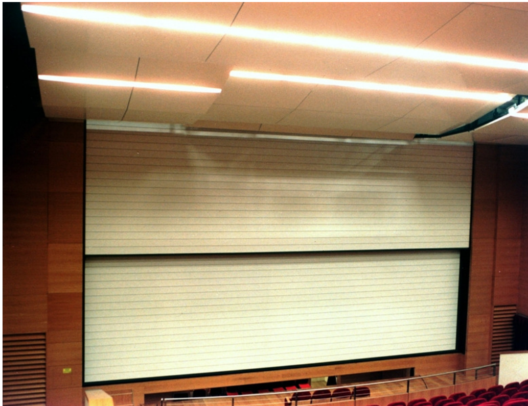
Figura 51 - Sipario di sicurezza tagliafuoco a doppia anta del Teatro "Lorenzo da Ponte" di Vittorio Veneto
