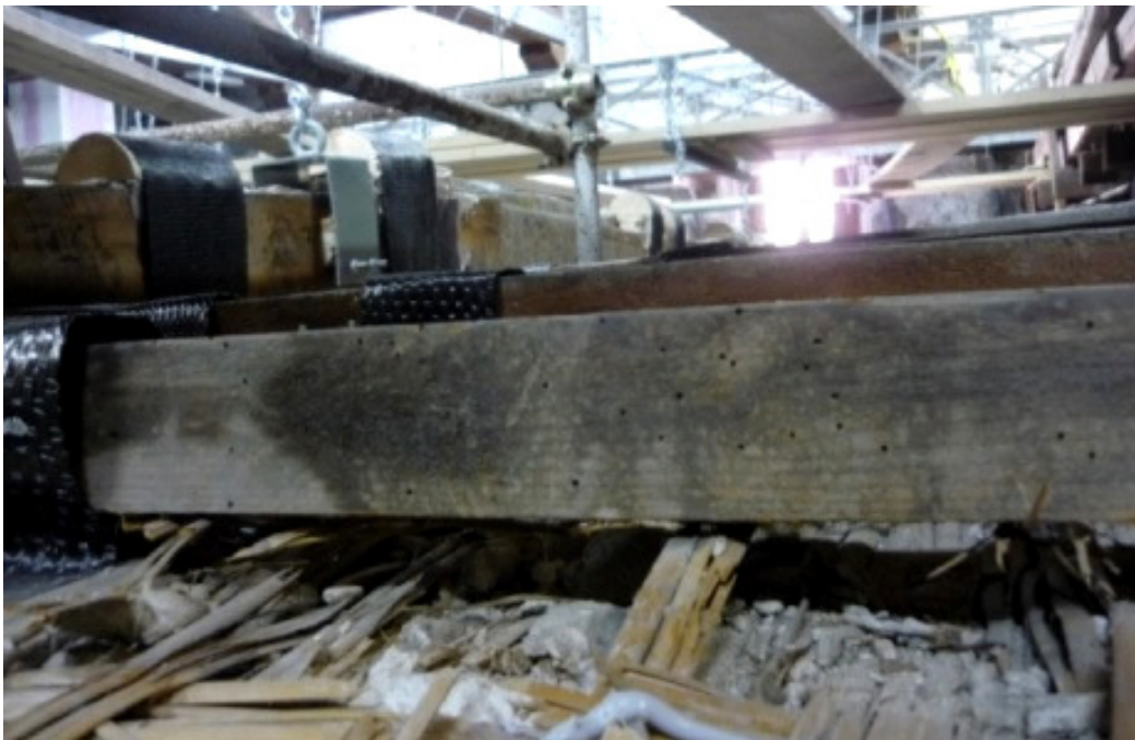
Figura 151 - Distacco tra struttura lignea e stuoiato
