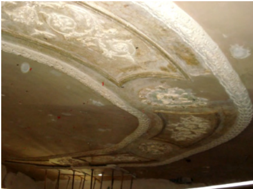
Figura 145 - Intradosso della volta in camorcanna prima dell'intervento
