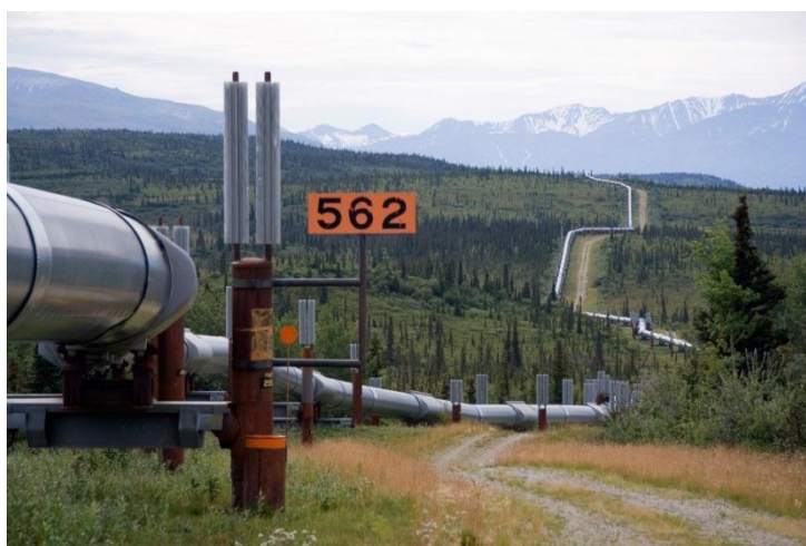
Figura 1.32. I termosifoni della Trans-Alaska Oil Pipeline che mantengono un bulbo di terreno gelato attorno ad ogni pilastro per prevenire il progressivo disgelo ed il conseguente cedimento del terreno di supporto.
