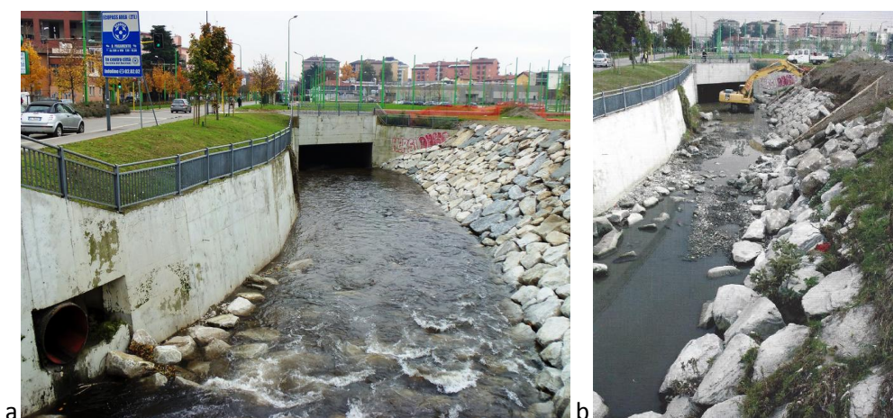
Figura 2-8: il fiume Seveso in corrispondenza dell'inizio della "tombinatura" a Milano, in via Ornato (a); 1°ottobre 2010 sono in corso lavori di ulteriore arginatura delle sponde (Foto di Bruno Grillini, fonte: (Centro Meteorologico Lombardo 2011)) (b).
