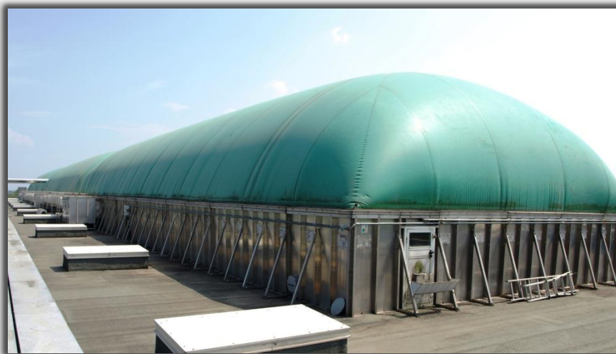
Figura 39 - Biofiltro coperto di Villafalletto.
